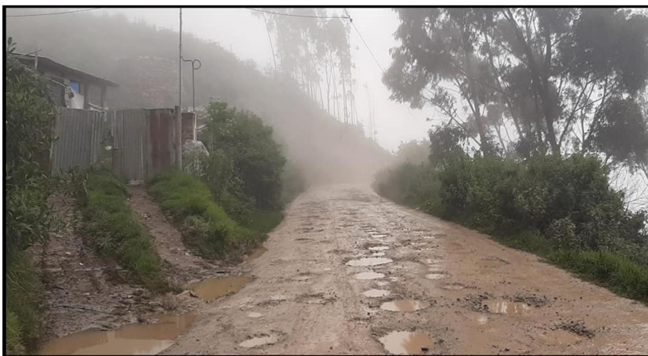
Figura 1. Superficie en mal estado de la vía Andahuaylas Ocobamba
