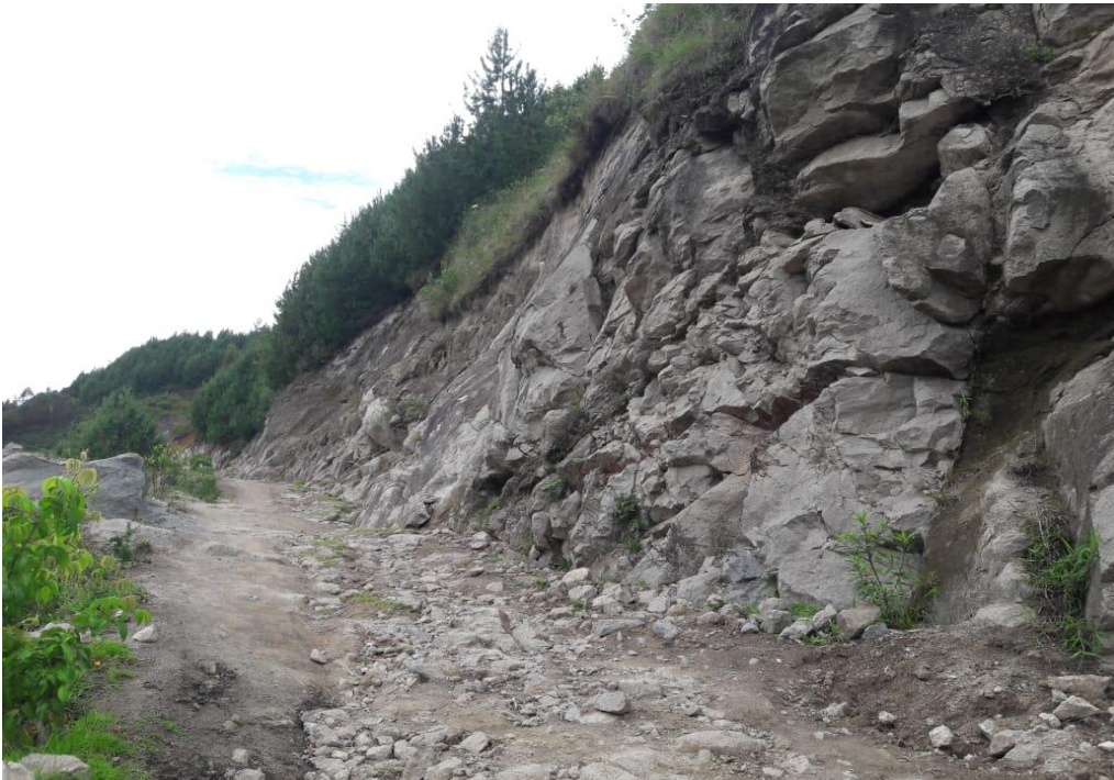
4. Se puede observar que la vía no presenta cunetas pluviales
