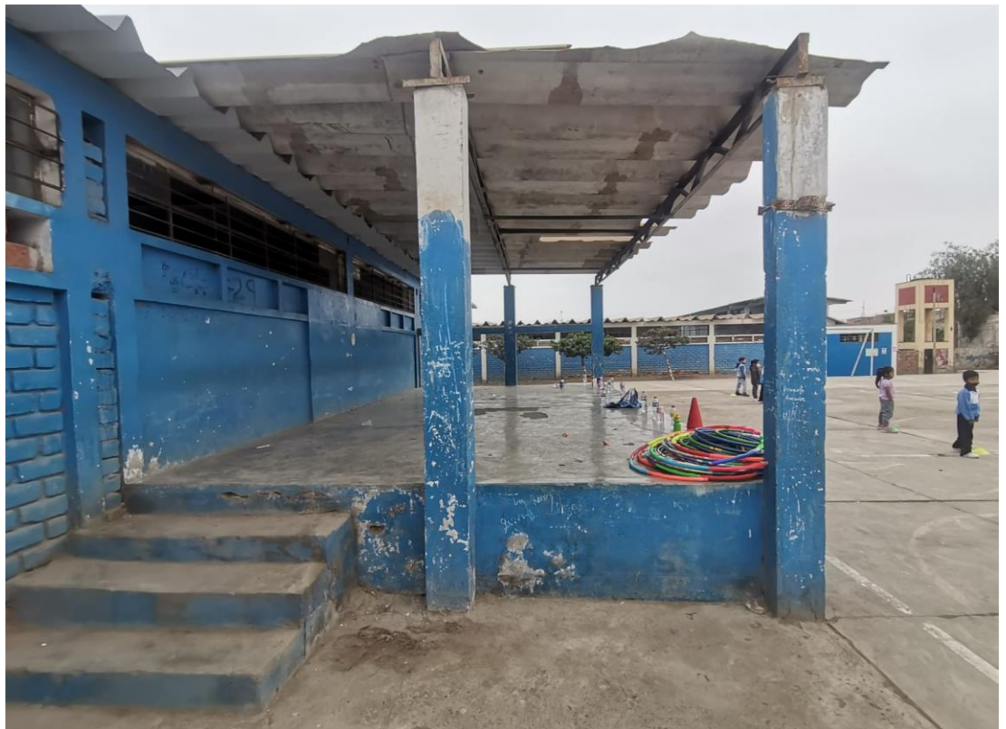
Fallas en los elementos estructurales al costado del pabellón estudiantil.
