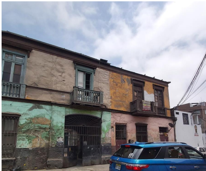
Fuente: Elaboración propia (2022) Viviendas patrimoniales en mal estado
