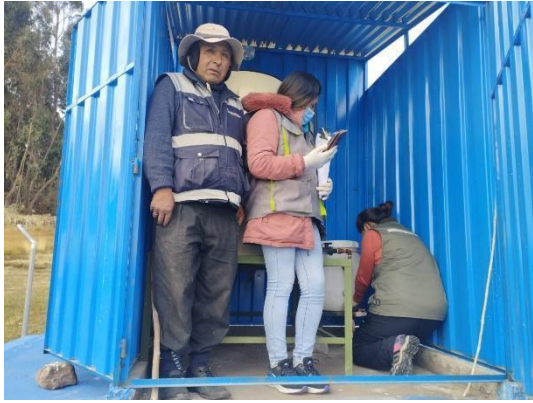
Figura 18. Calibración del sistema de cloración por goteo.
