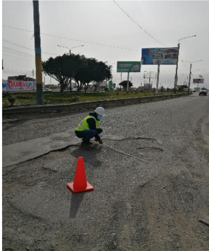
Figura 6 Bacheos, desintegración de bordes del pavimento
