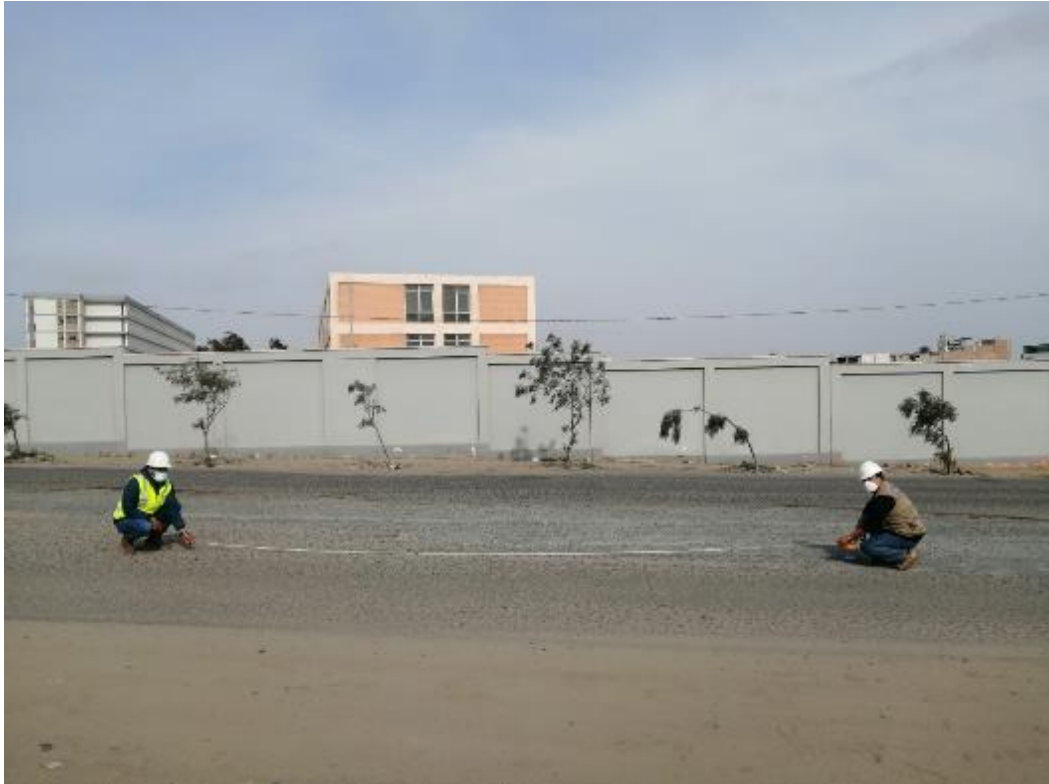
Figura 4 Bacheo, pérdida de agregados, desintegración de bordes del pavimento
