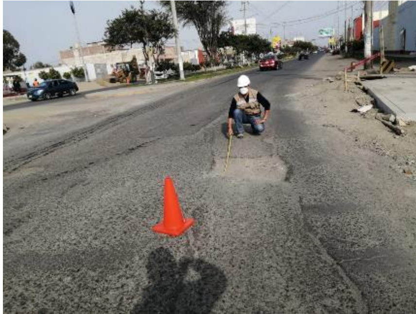
Figura 2 Bacheo, fisura de borde y fisura longitudinal en Av. Pacífico
