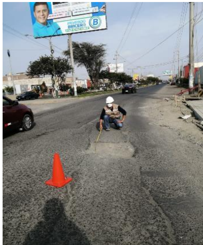
Figura 7 Bacheos, Desintegración de bordes del pavimento
