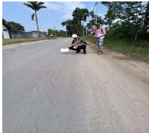
Imagen de grietas long. y transv.
