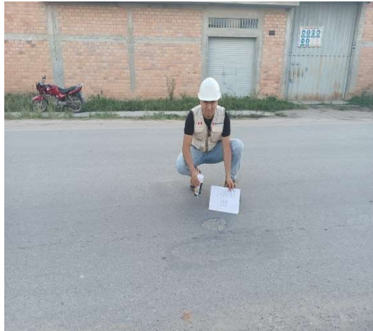
Desprendimiento de agregados
