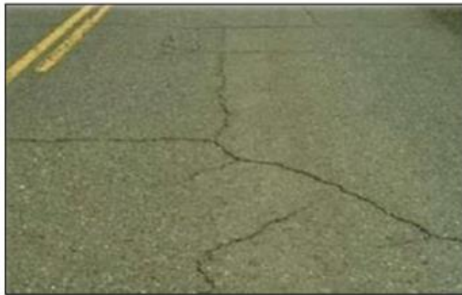
Anexo 1.7. Fisuras de contracción térmica
