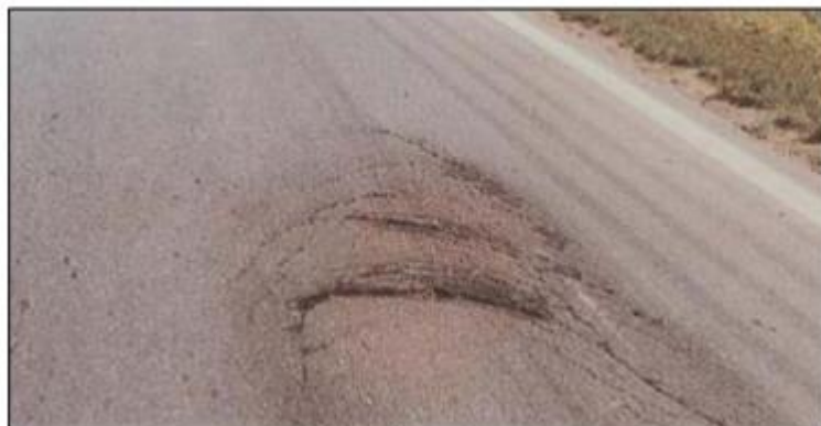
Anexo 1.8. Fisuras parabólicas
