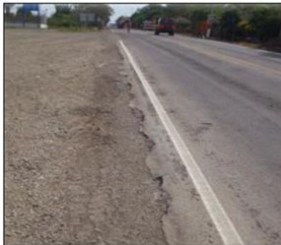
Anexo 1.22. Erosión de bermas
