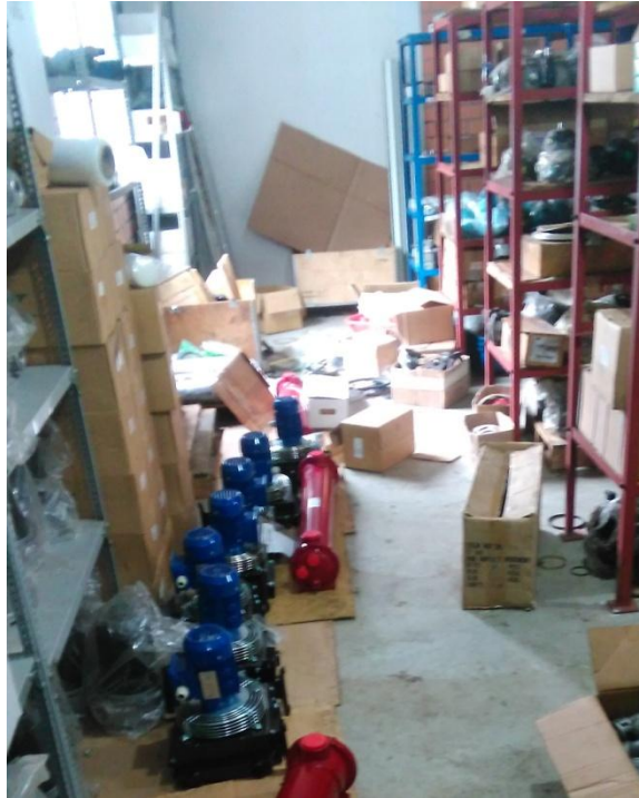
Figura 14. Andamios no identificados, componentes ubicados suelo por falta de identificación de ubicación de componentes
