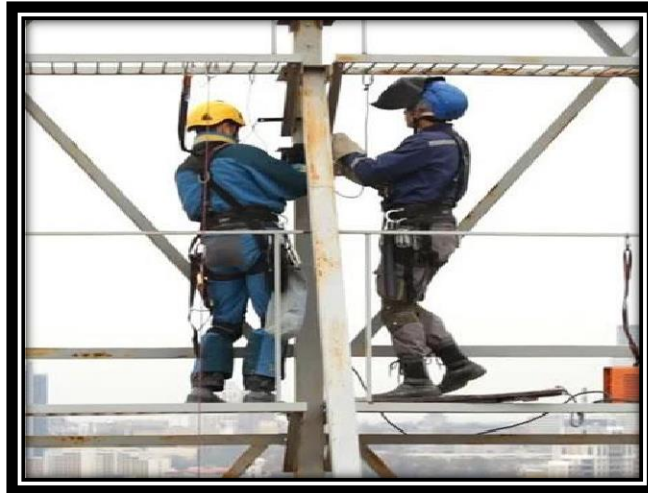
Figura 8. Evidencia de carencia sujetadores magnéticos
