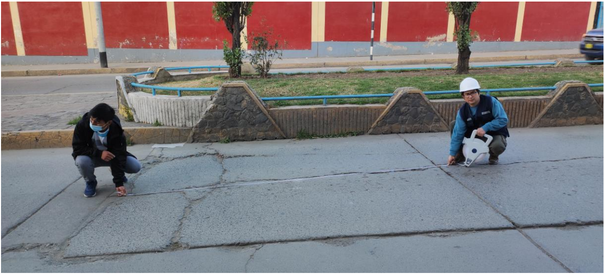
Figura 3. Evaluación de losa dividida con severidad alta (23H).
