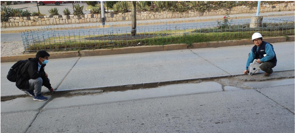
Figura 6. Evaluación de parche grande con severidad alta (29H).
