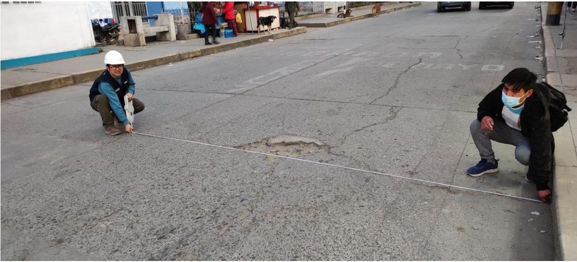
Figura 5. Evaluación grieta lineal con severidad media (23M).
