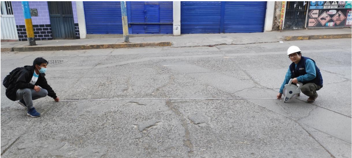
Figura 6. Evaluación de dividida con severidad alta (23H).
