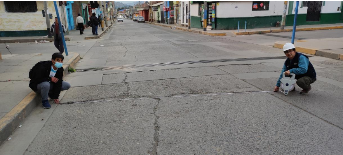
Figura 4. Evaluación de losa dividida severidad alta (23H).
