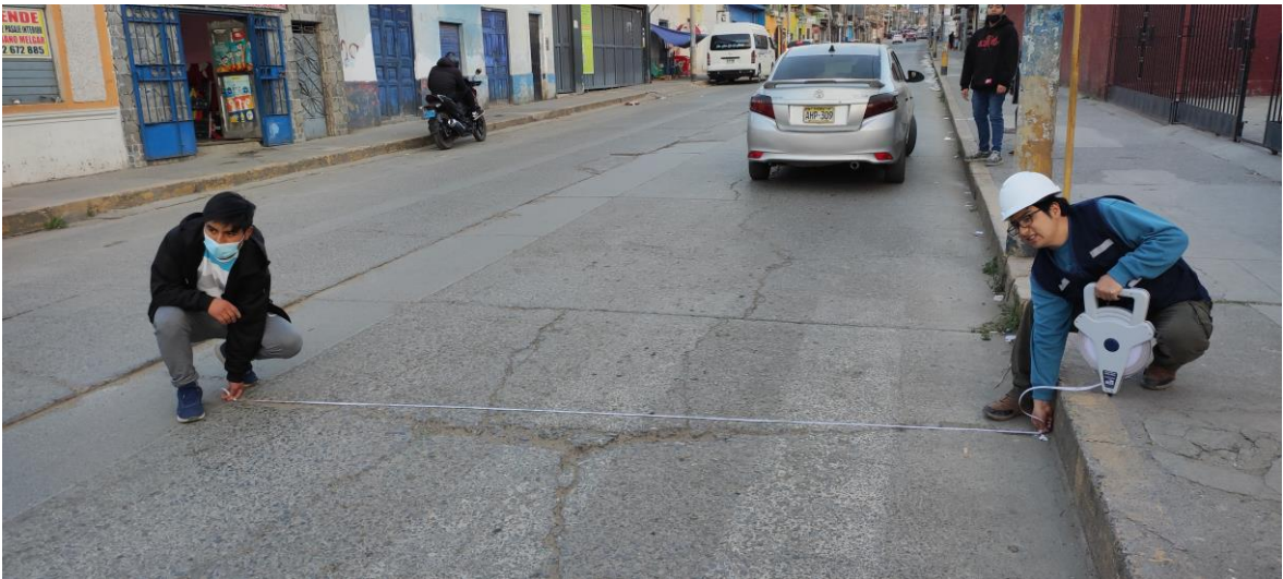
Figura 6. Evaluación de dividida con severidad alta (23H).
