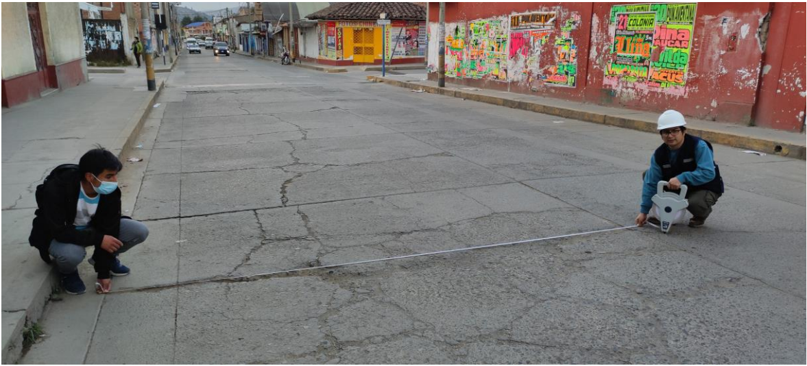
Figura 5. Evaluación de losa dividida con severidad alta (23H).
