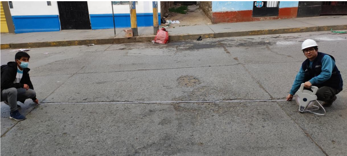
Figura 6. Evaluación de losa dividida con severidad media (23M).
