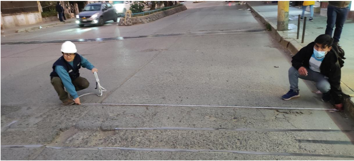
Figura 3. Evaluación de pulimiento con severidad alta (31H).
