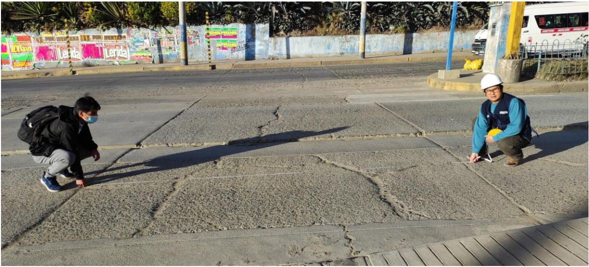
Figura 6. Evaluación de dividida con severidad alta (23H).
