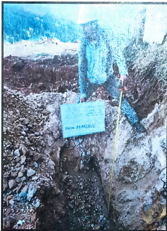
Fotografía 11. Se observa la toma de medidas de la calicata N° 06 Jr. El Mirador
