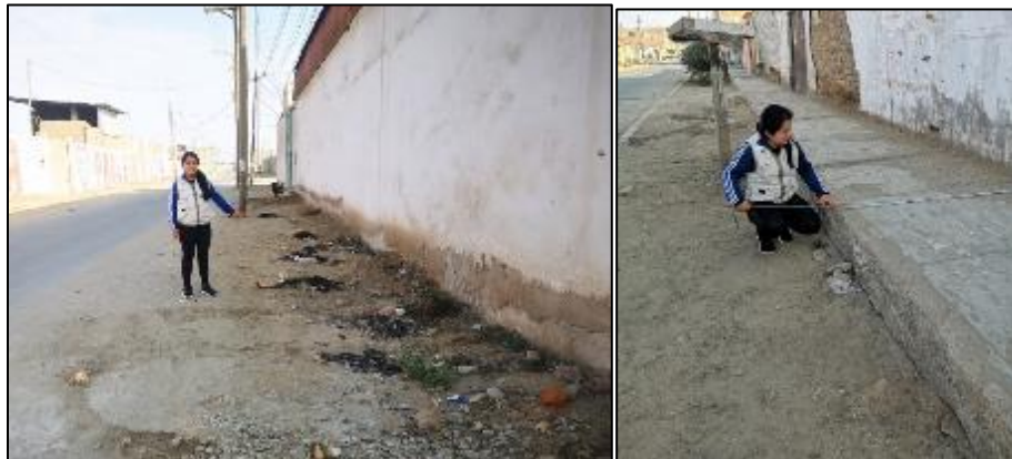
Figura 5. Inspección pavimento rígido calle Callao.
