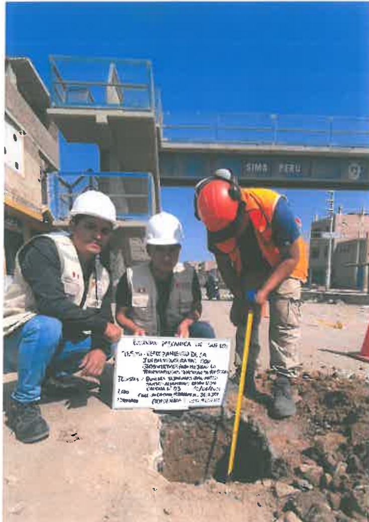
FOTOGRAFÍA 03: Muestra la ubicación de la calicata C – 03 del proyecto: "Reforzamiento de la Infraestructura Vial con Geomalla para Mejorar la Transitabilidad Vehicular de la Av. Chiclayo, José Leonardo Ortiz"
