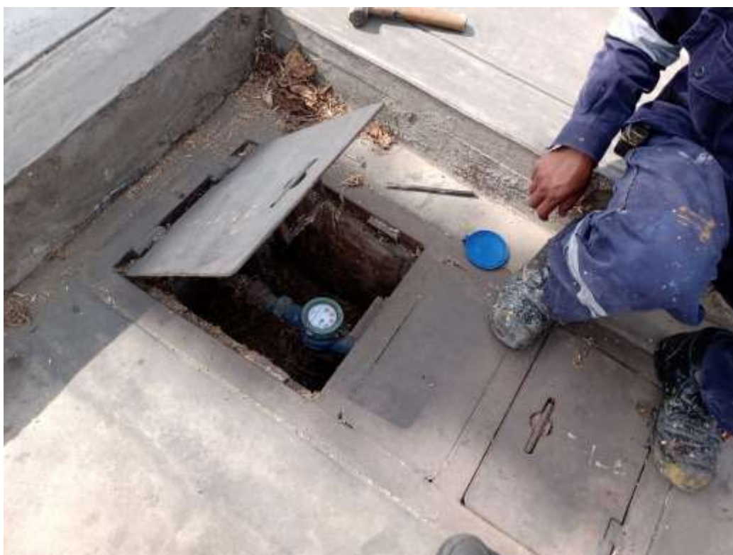
Medidor de agua comedor SIMA Callao
