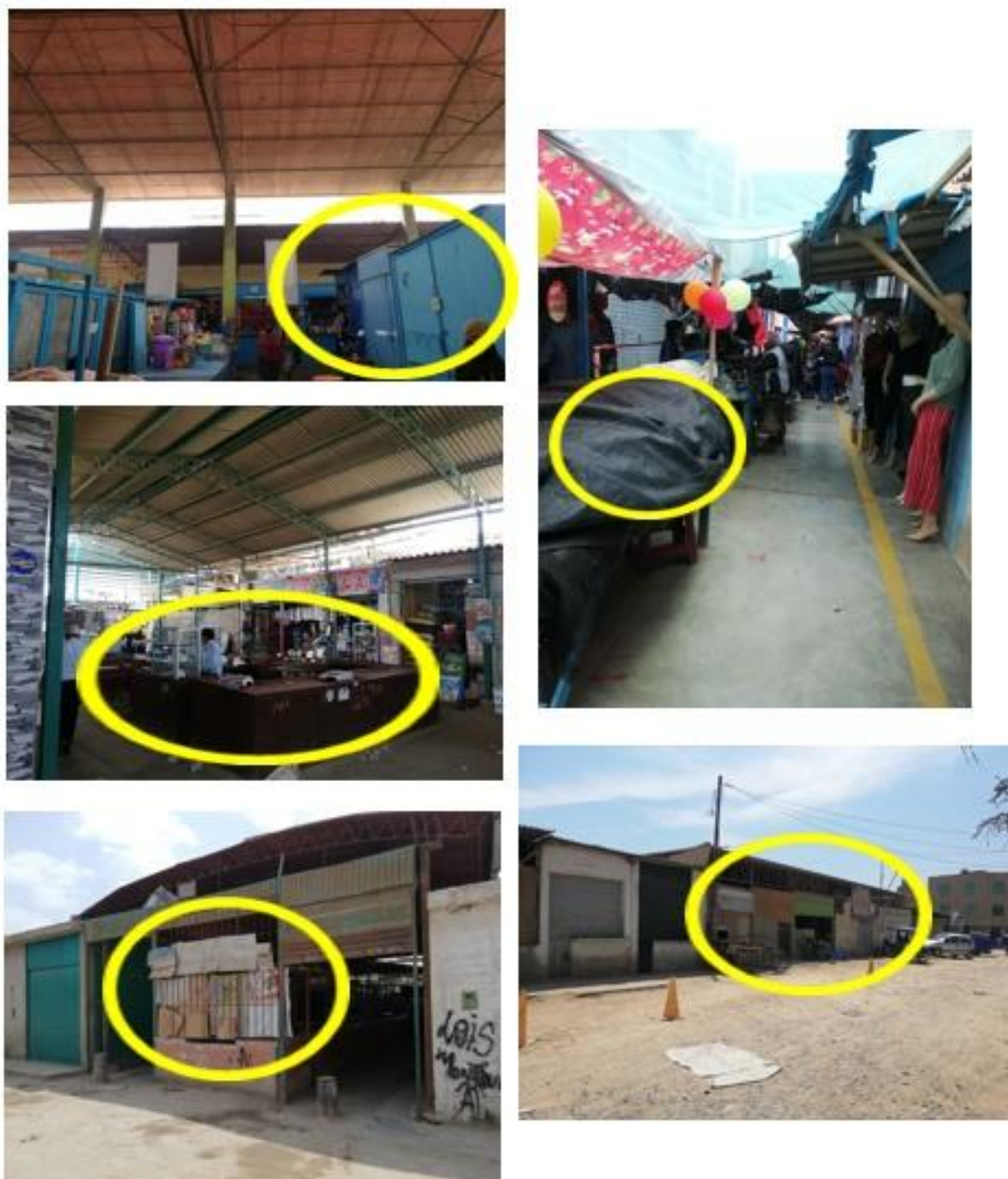
Figura 56. Fotografías de las tipologías de materiales empleados inadecuados.
