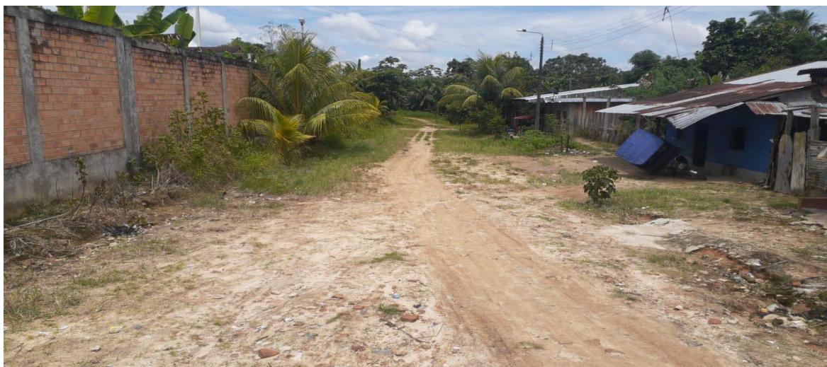
Figura 2. Terreno natural en mal estado de la calle Juan Vásquez cuadra 1
