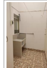
FUENTE: Imagen del Patio de servicio del Módulo Básico de Vivienda Tipología III.
