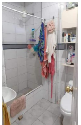
FUENTE: Imagen del Servicio Higiénico del Dormitorio Principal Módulo Básico de Vivienda Tipología II.
