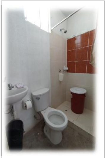
FUENTE: Imagen del Servicio Higiénico del Módulo Básico de Vivienda Tipología I.
