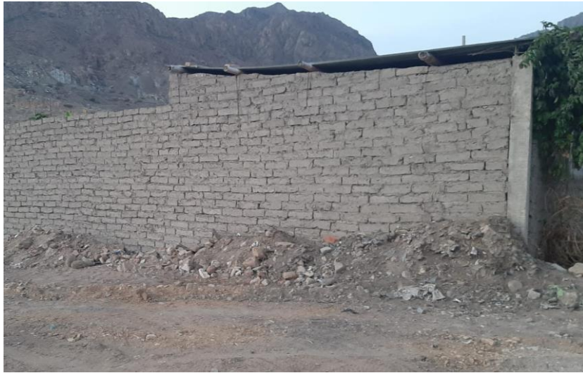
Figura 2: Registro de degradación, debilitación del adobe, causas de humedad.
