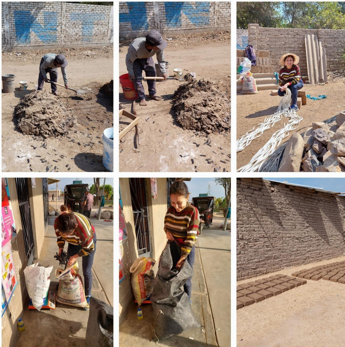
Incorporación de polietileno y cal, batido de materiales para elaboración de adobe.
