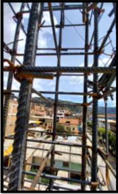
Figura N° 11: Se observa que el gancho de los estribos es demasiado corto estructural
