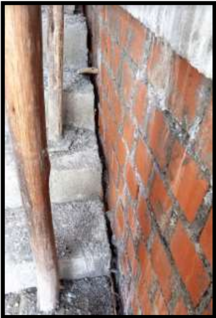
Figura N° 13: Se observa una separación entre el muro y la escalera
