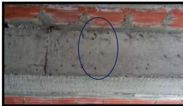
Figura N° 18: Fisura de un elemento estructural
