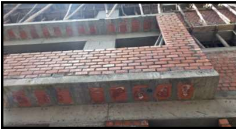
Figura N° 17:Falta de columnetas en los voladizos
