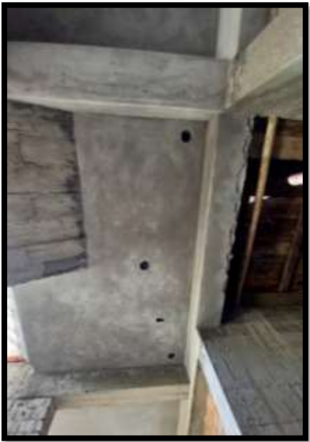
Figura N° 14: Se observa un mal vaciado de un elemento estructural
