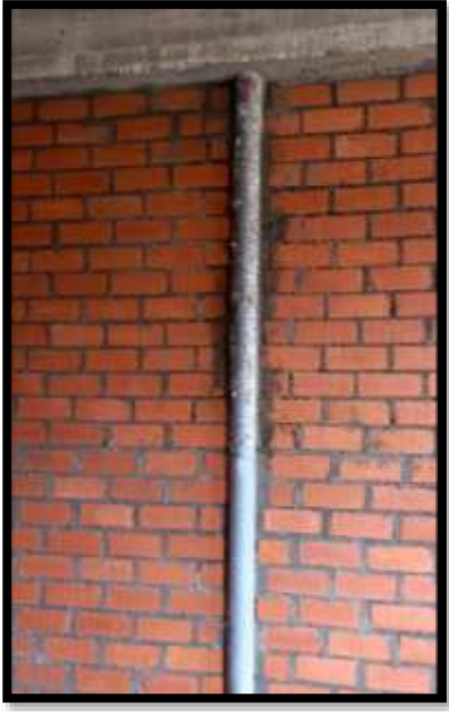
Figura N° 12: Se observa que las instalaciones sanitarias atraviesan por un
