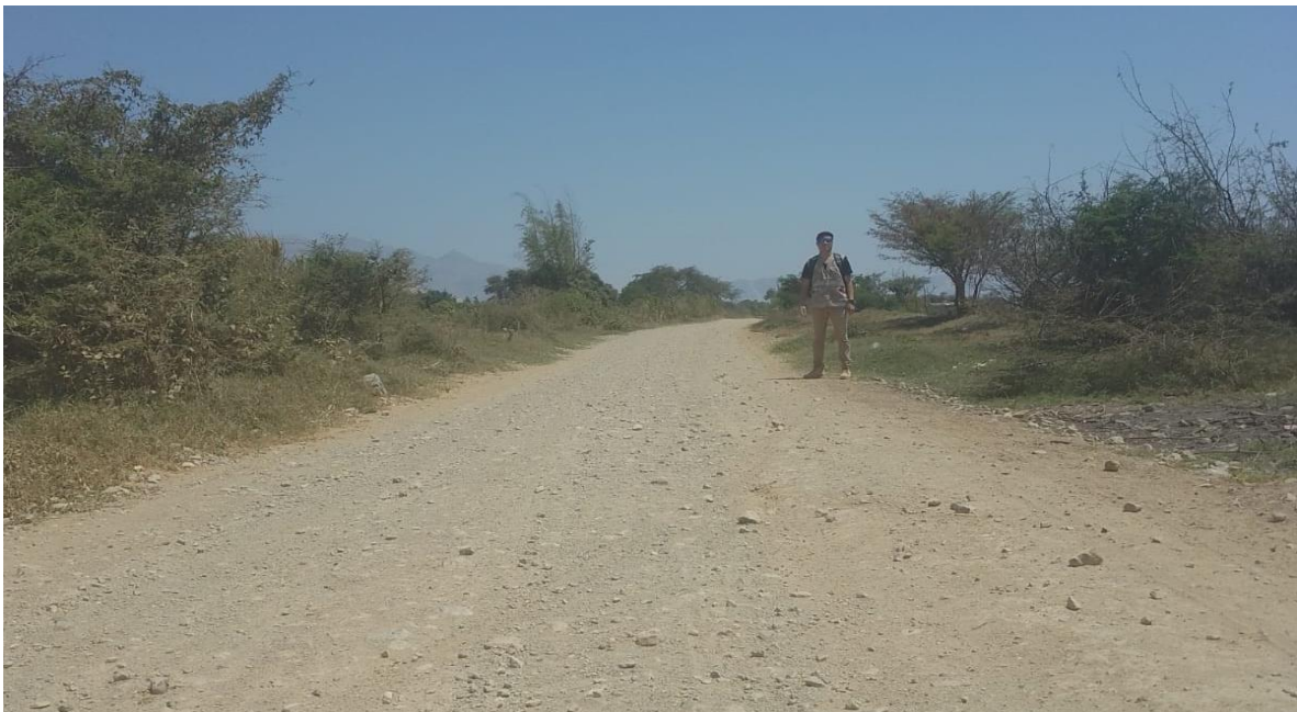
Foto N° 2. Carretera del centro poblado Puente Mayta: Km 5+960 coordenadas UTM X=676560.4579; Y=9193276.5572; Z=145.67 msnm.
