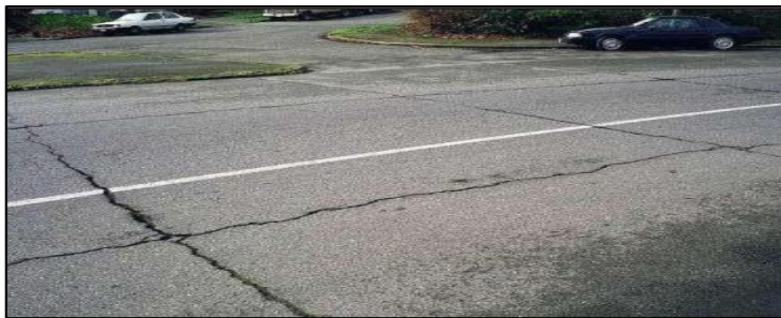
Figura 12. Fisura de reflexión de junta
