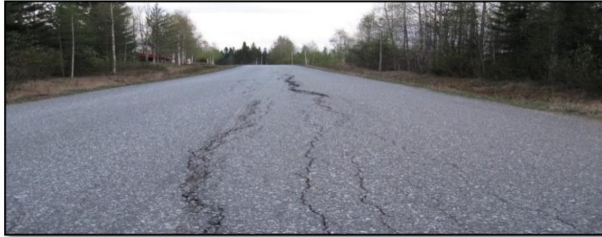
Figura 14. Grieta transversal y longitudinal
