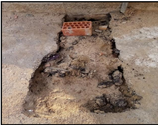
FOTO 04: Fallas del Pavimento Flexible
