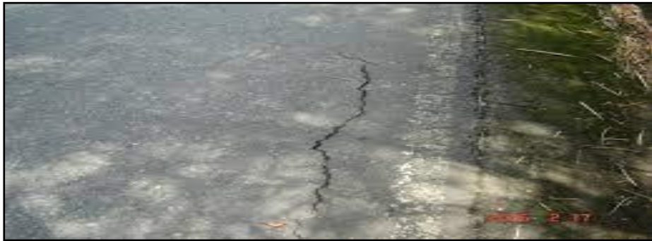
Figura 11. Fisura de borde (grieta)
