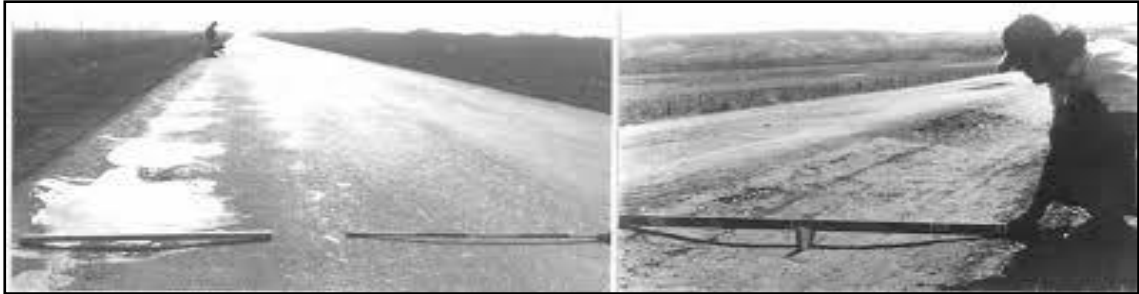
Figura 8. Abultamiento y Hundimiento
