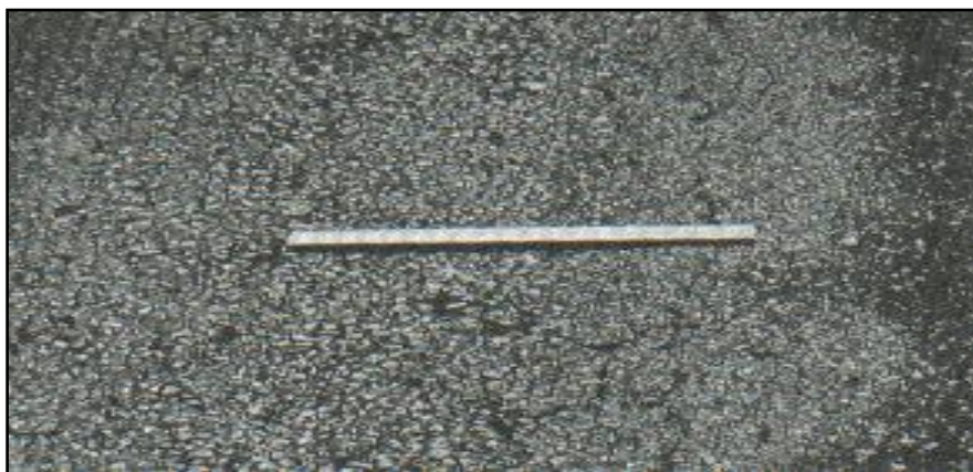
Figura 24. Desprendimiento de agregados
