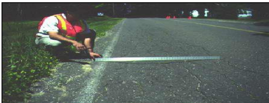
Figura 10. Depresión en un pavimento
