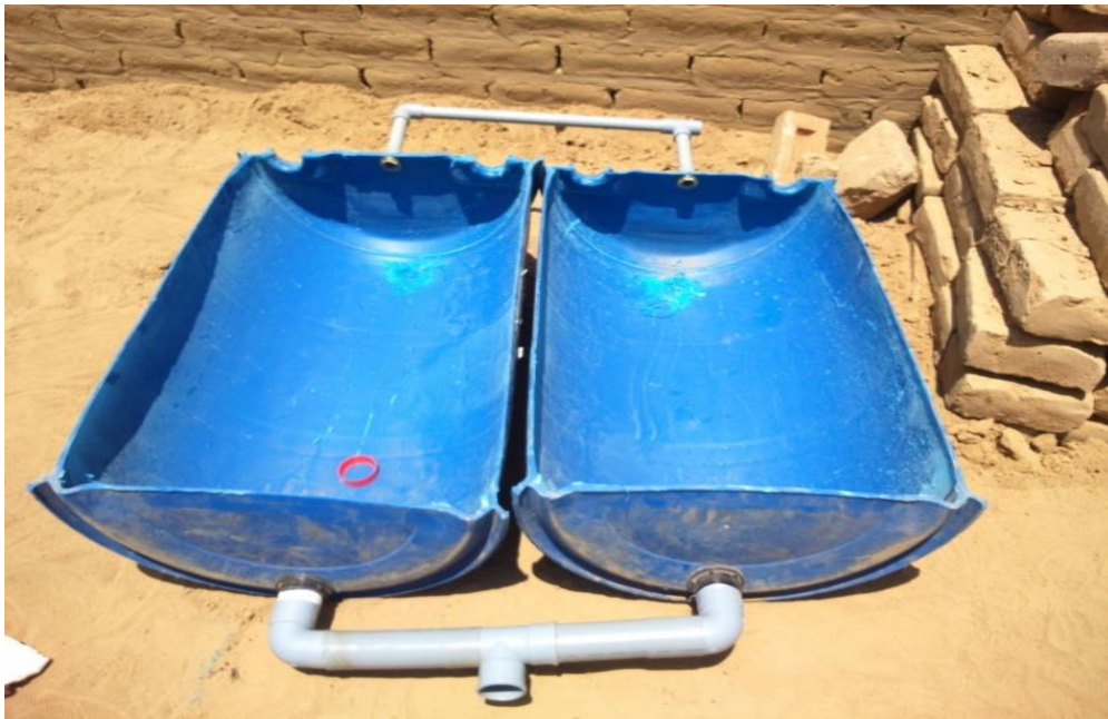
FIGURA N°18 Instalación de tubos y espacios por los cuales se recibirá el agua residual para el tratamiento.
