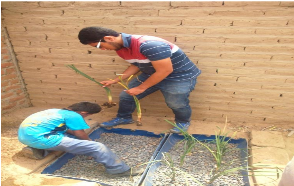
FIGURA N°20 Se observa la implementación de la grava y eneas las cuales son la principal fuente purificadora de las aguas residuales en la institución.
