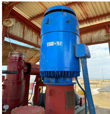
Figura 10. Bomba contra incendio 11G-30 – Zona de patio tanques
