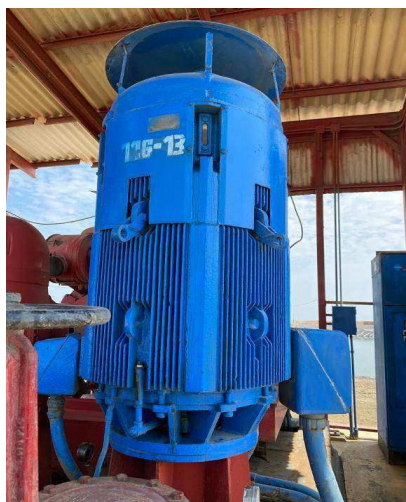
Figura 8. Bomba principal 11G-13 – Zona de patio tanques
