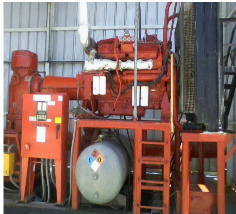
Figura 12. Bomba contra incendio 12G-119 – Zona de muelle
