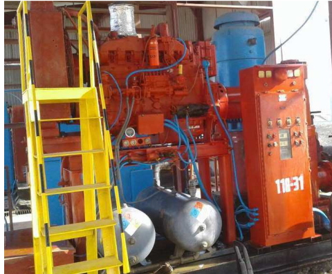
Figura 11. Bomba contra incendio 11G-31 – Zona de patio tanques
