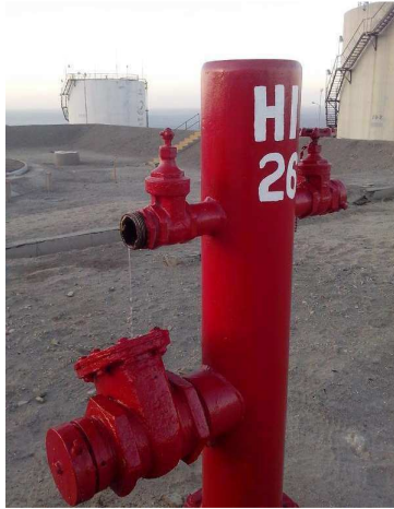
Figura 19. Hidrante contra incendios
