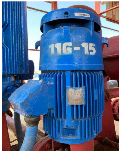
Figura 7. Bomba Jockey 11G-15 – Zona de patio tanques
