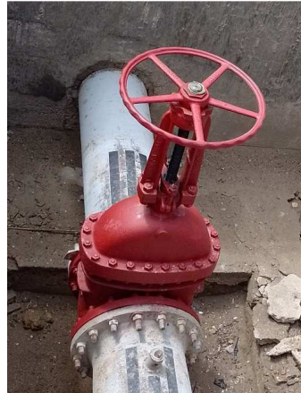
Figura 17. Válvula de control de la descarga
