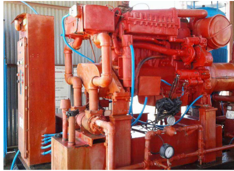
Figura 9. Bomba contra incendio 11G-14 – Zona de patio tanques
