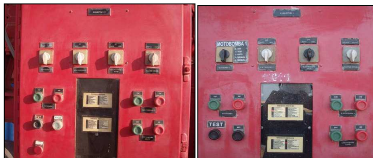
Figura 18. Panel de control de bombas contra incendio
