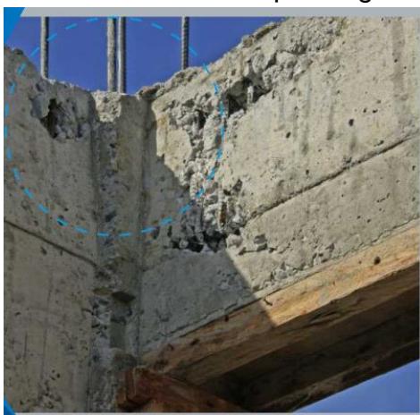
Figura 20. Cangrejas por mala segregación
