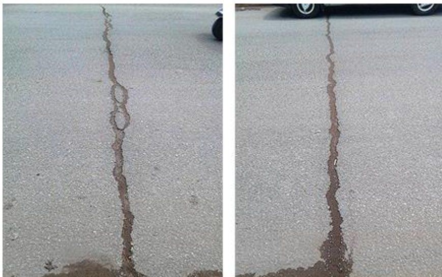
Anexo 22. Grietas transversales
