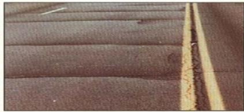
Figura 7. Grieta por reflexión
