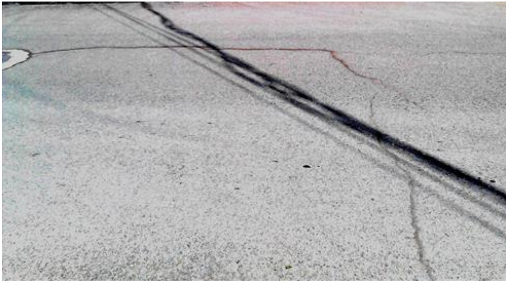
Anexo 19. Grieta parabólica
