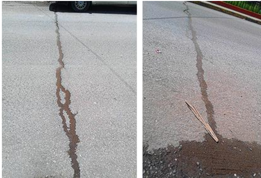
Anexo 17. Grieta transversal
