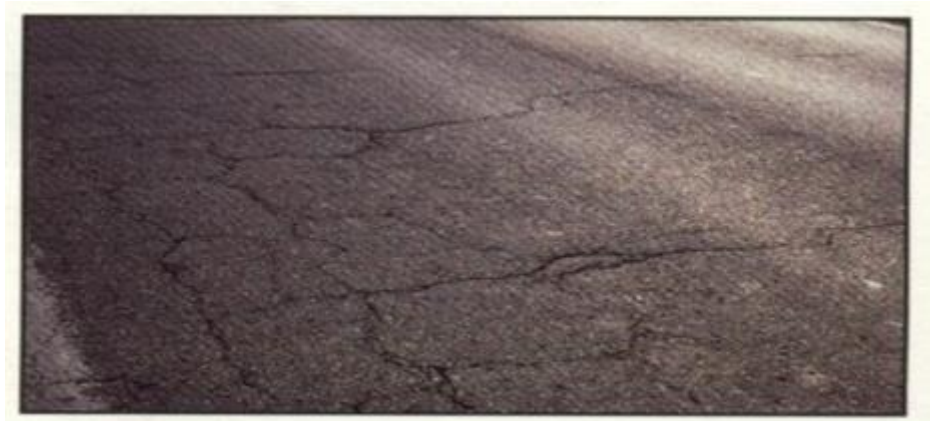
Figura 6. Grietas por contracción
