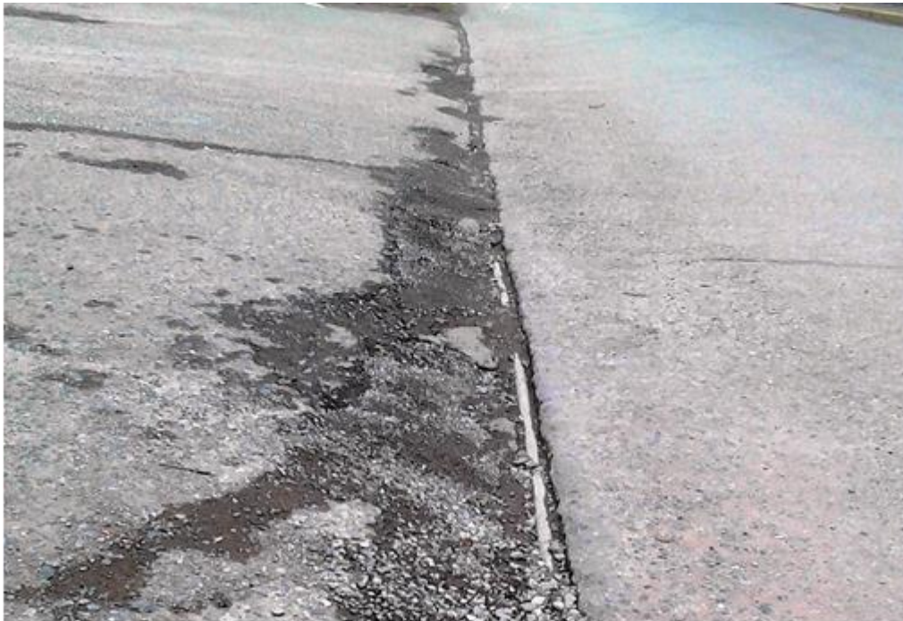
Anexo 18. Desplazamiento y grieta de reflexión de junta
