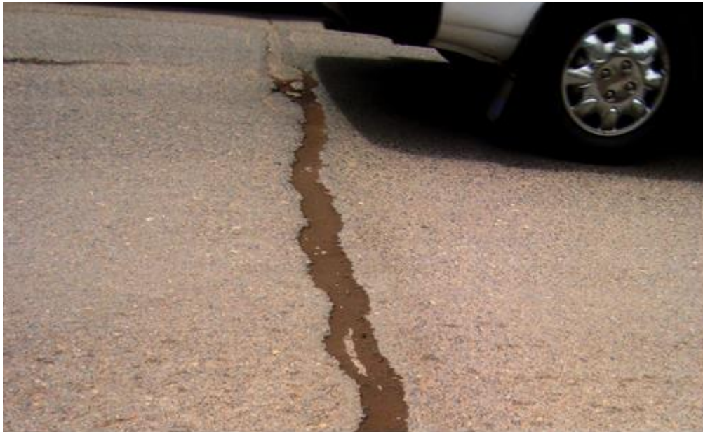
Anexo 13. Grietas transversales
