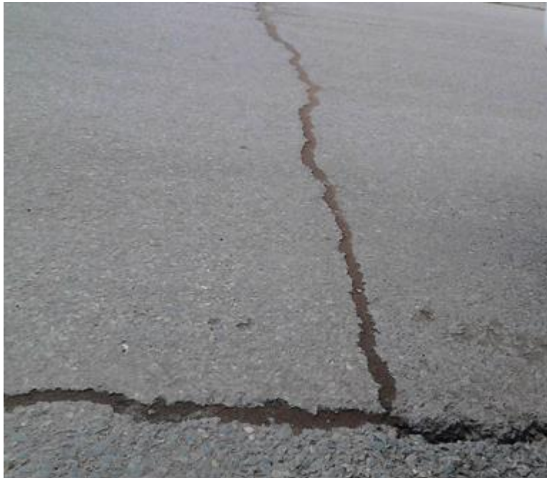
Anexo 21. Grieta de reflexión de junta
