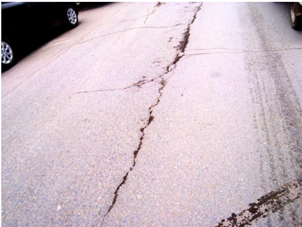
Anexo 12. Grieta de reflexión de junta
