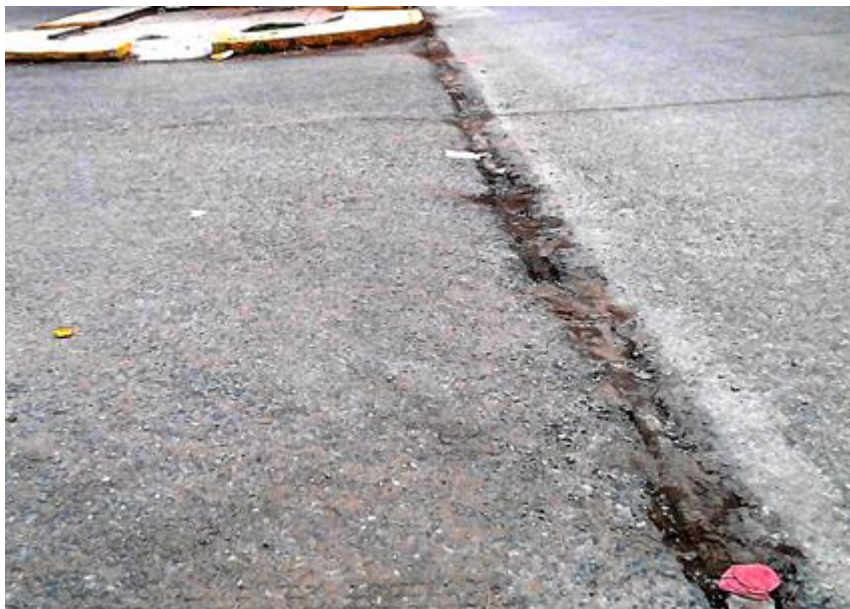
Anexo 20. Grieta de reflexión de junta
