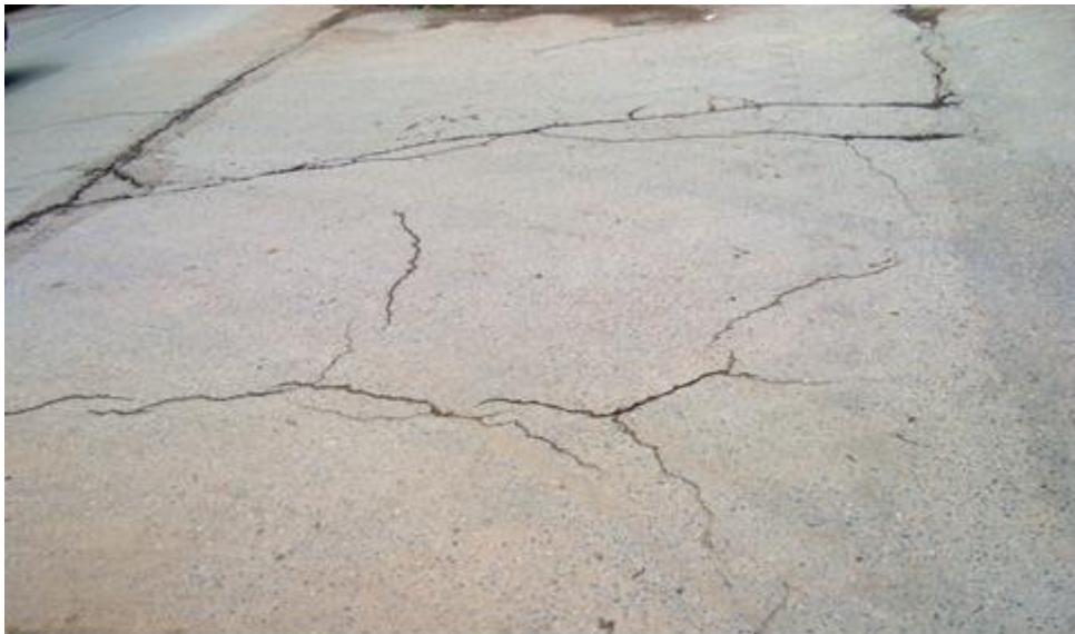
Anexo 8. Agrietamiento en bloque
