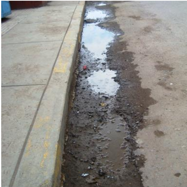
Anexo 7. Grieta de borde
