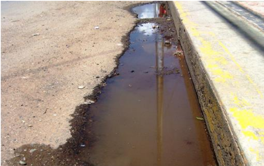
Anexo 15. Grieta de borde
