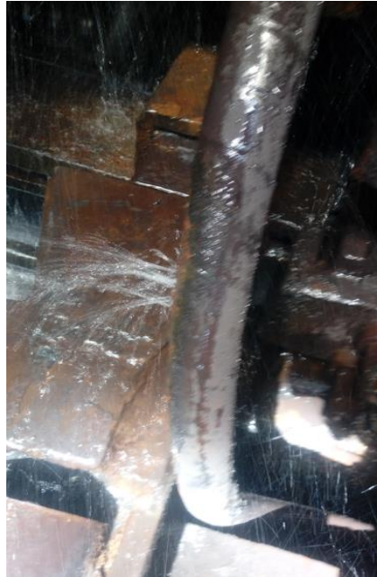
MANGUERA CON FUGA DE AGUA
