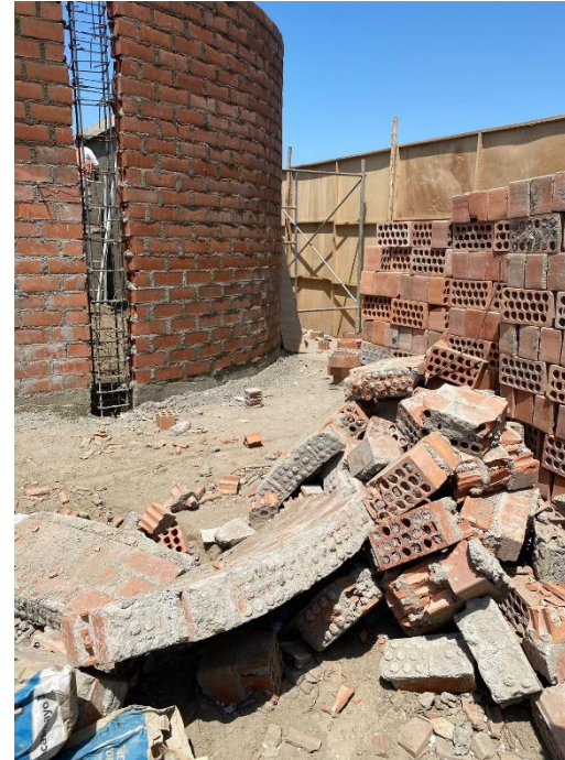
Figura 10. Se observa la presencia del material excedente y residuos en obra que no han sido eliminados
