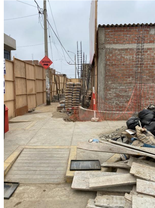
Figura 14. Falta de control en el área de almacén
