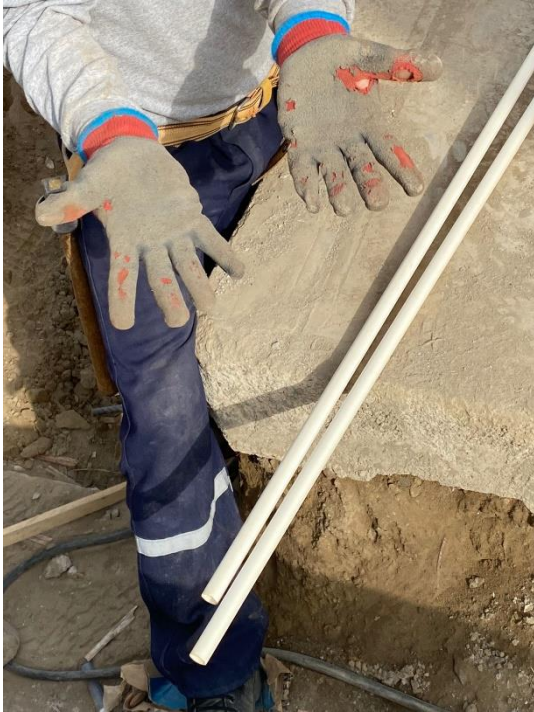
Figura 11. Falta de equipos de protección personal, lo que impide el desarrollo de las actividades
