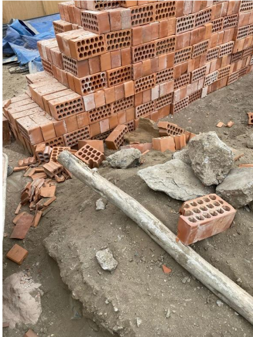
Figura 9. Desorden y falta de limpieza en diversas áreas
