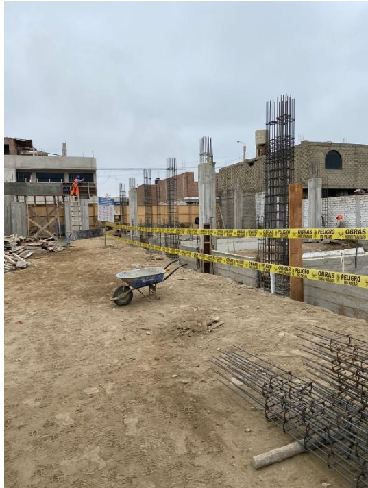
Figura 13. Poca presencia de personal en obra
