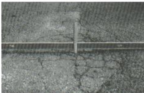
Figura A6-b. Depresión de severidad media.
