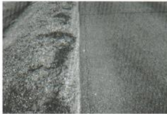
Figura A7-a. Grieta de borde de baja severidad.
