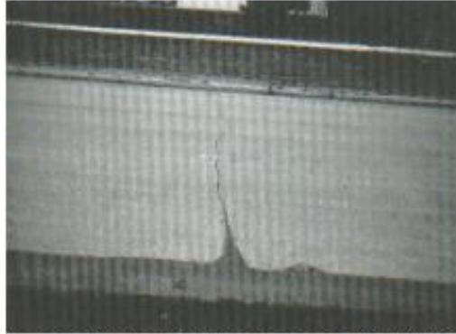
Figura A10-a. Grietas longitudinales y transversales (No PCC) de baja severidad.
