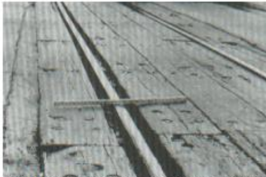
Figura A14-b. Cruce de vía férrea de severidad media.
