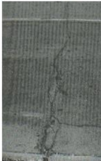
Figura A8-b. Grieta de reflexión de junta de severidad media.
