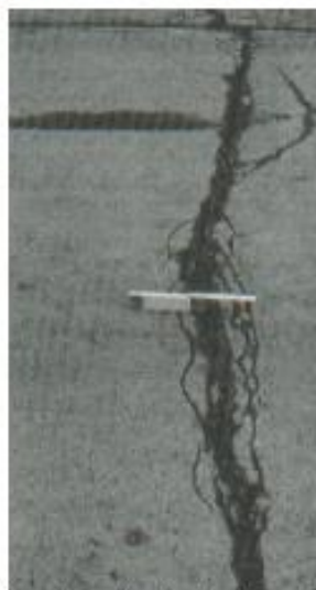
Figura A8-c. Grieta de reflexión de junta de alta severidad.
