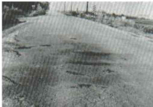
Figura A16-b. Desplazamiento de severidad media.
