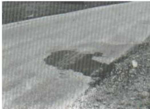
Figura A11-b. Parcheo y acometidas de servicios públicos de severidad media.
