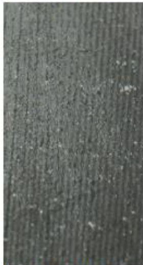
Figura A2-c. Exudación de alta severidad.
