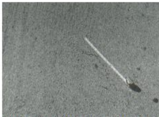
Figura A17-a. Grieta parabólica (slippage) de baja severidad.
