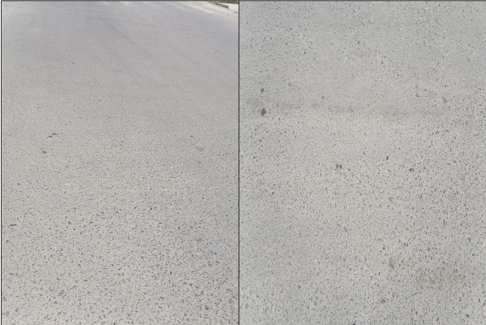
Fotografía 17. Falla por meteorización/ desprendimiento de agregados con severidad baja en el pavimento del pueblo joven (PPAO)
