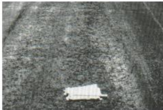
Figura A19-b. Meteorización / desprendimiento de agregados de severidad media.
