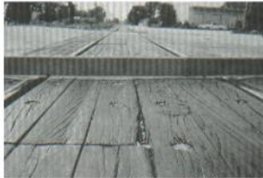
Figura A14-a. Cruce de vía férrea de baja severidad.
