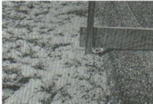
Figura A9-a. Desnivel carril / berma de baja severidad.
