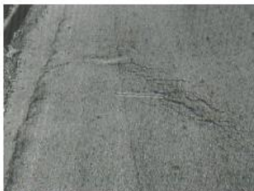
Figura A17-b. Grieta parabólica (slippage) de severidad media.
