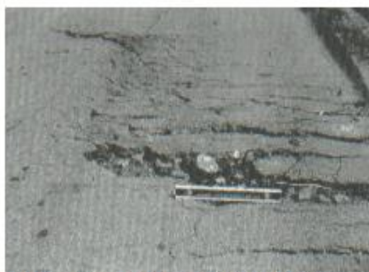
Figura A17-c. Grieta parabólica (slippage) de alta severidad.
