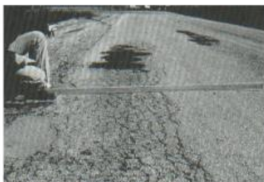
Figura A1-c. Piel de cocodrilo de alta severidad.
