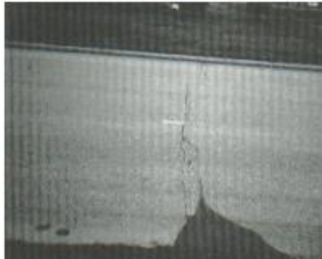
Figura A10-b. Grietas longitudinales y transversales (No PCC) de severidad media.
