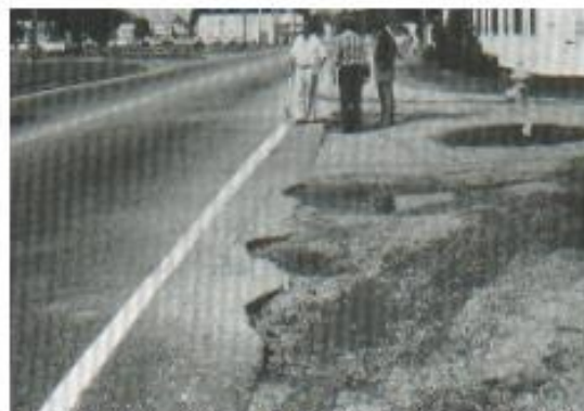
Figura A7-c. Grieta de borde de alta severidad.
