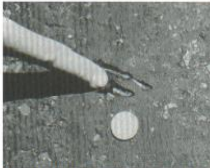
Figura A2-b. Exudación de severidad media.
