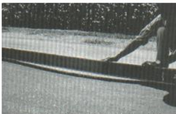
Figura A6-c. Depresión de alta severidad.
