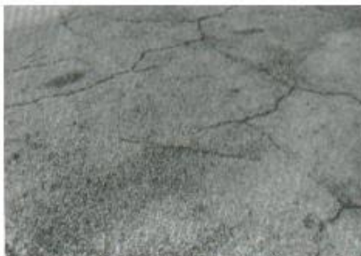
Figura A3-a. Grietas en bloque de baja severidad.
