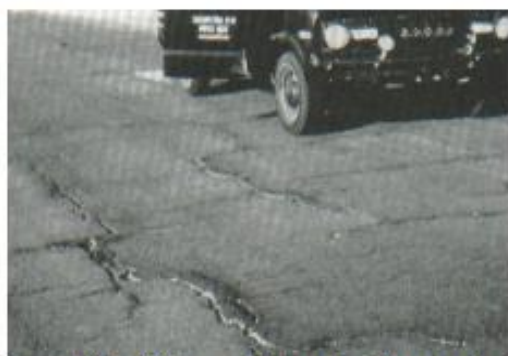
Figura A3-c. Grietas en bloque de alta severidad.
