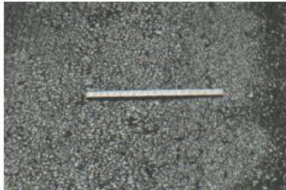
Figura A19-a. Meteorización / desprendimiento de agregados de baja severidad.
