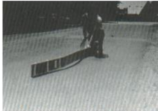
Figura A16-a. Desplazamiento de baja severidad.
