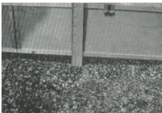
Figura A15-c. Ahuellamiento de alta severidad.
