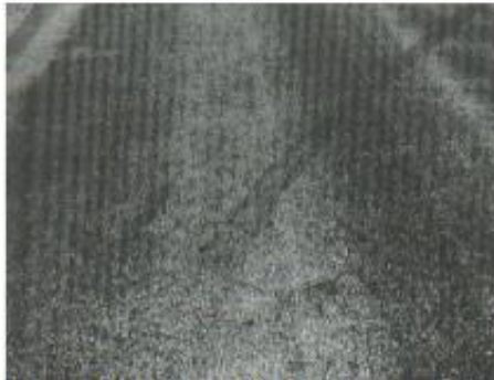
Figura A2-a. Exudación de baja severidad.
