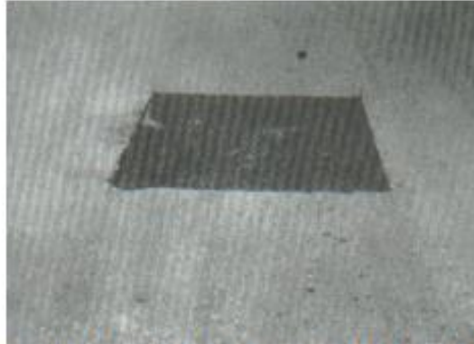
Figura A11-a. Parcheo y acometidas de servicios públicos de baja severidad.
