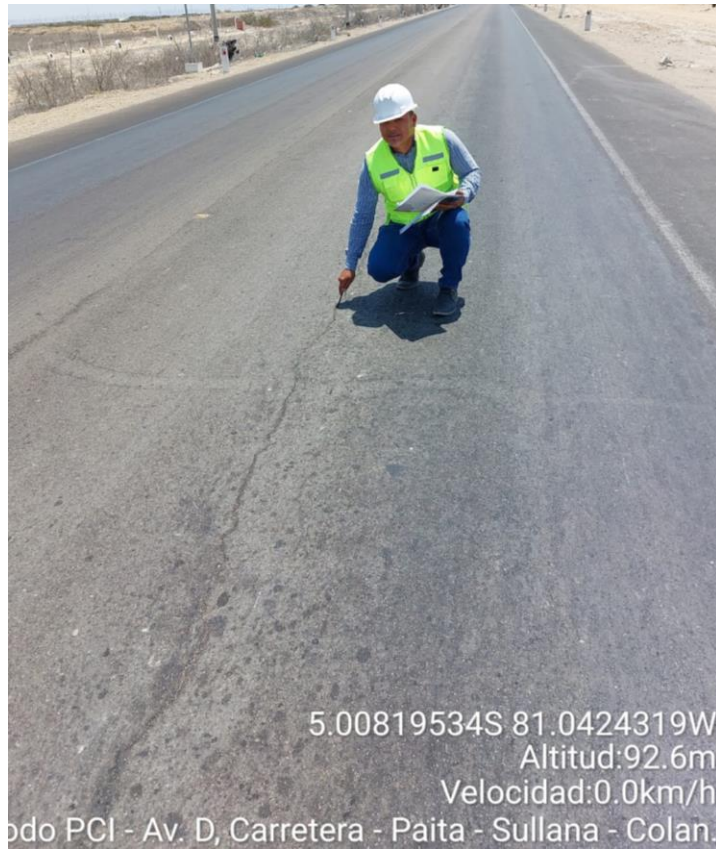
Identificación Visual de Patologías: Grietas Longitudinales
