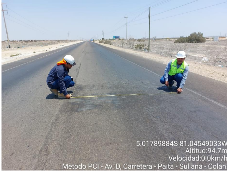
Medición del daño Huecos
