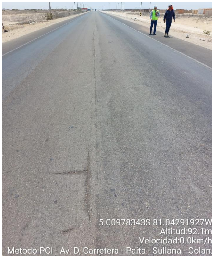
Grietas Longitudinales / Pulimiento de Agregados
