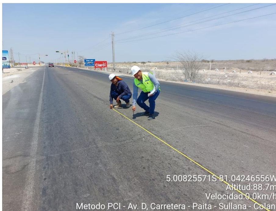
Medición de Grieta Longitud
