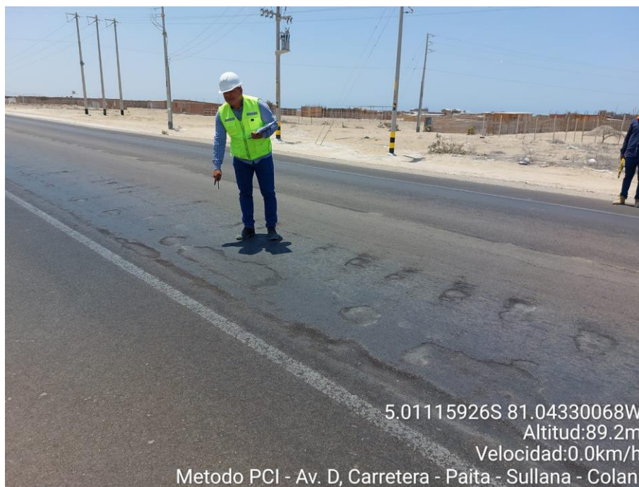
Identificación Visual de la Patología Huecos
