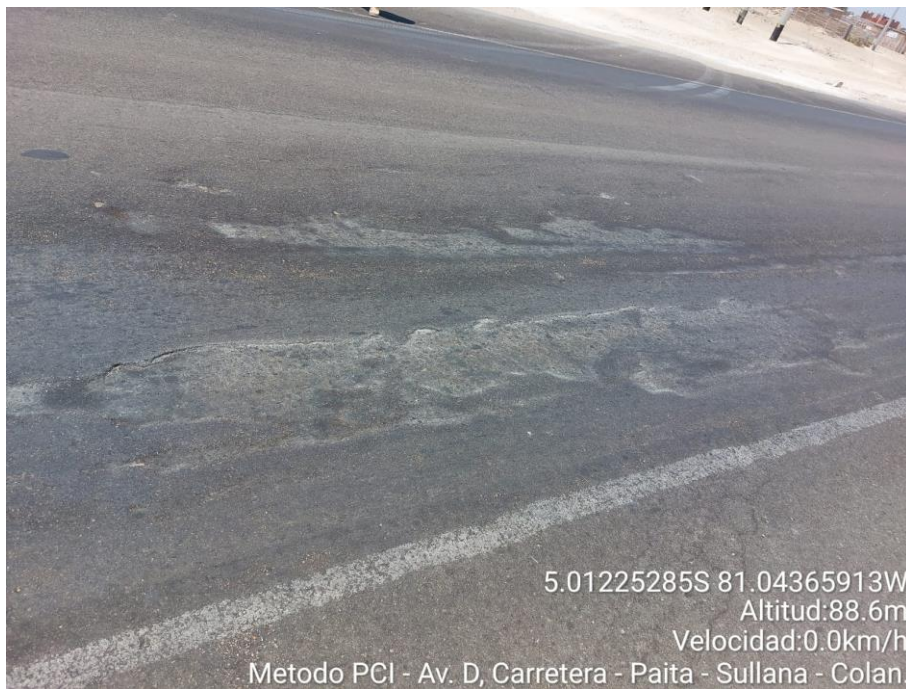
Patología: Fisura Transversal de Severidad Alta
