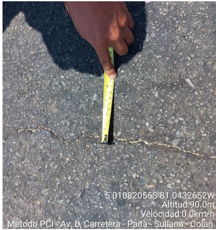
Medición de Grieta Longitudinal
