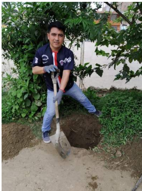
Franco Villalaz realizando excavación de calicatas para extracción de muestras para estudio de suelos.
