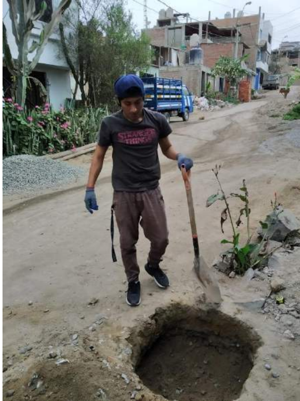
Vieri Zamudio realizando excavación de calicatas para extracción de muestras para estudio de suelos.
