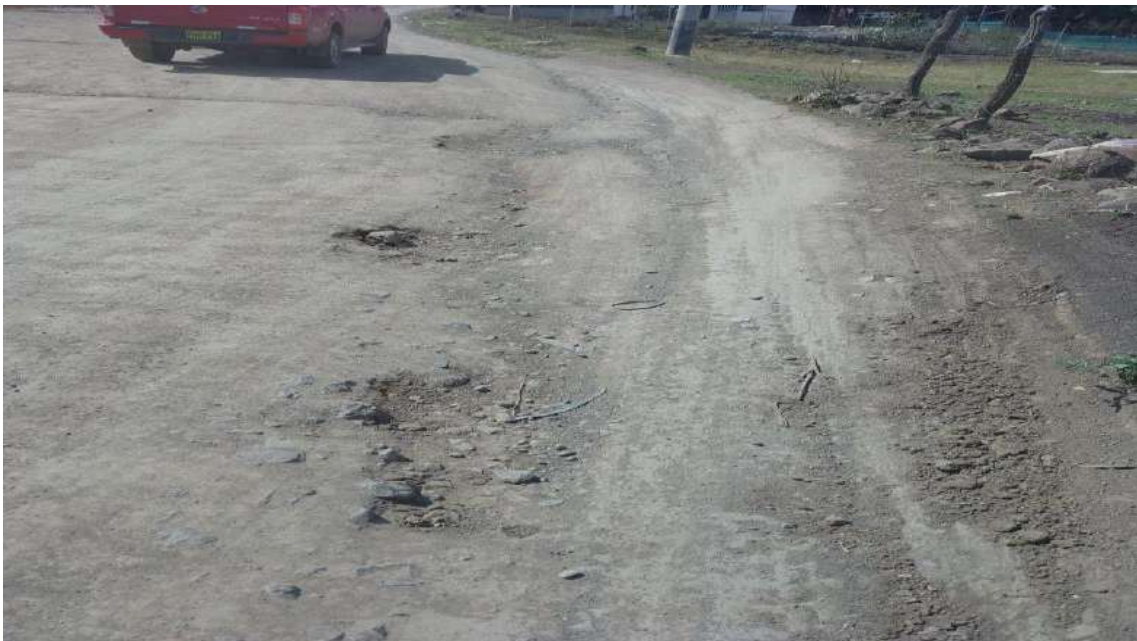
Figura 4. Carretera en Malas Condiciones por las Constantes Lluvias
