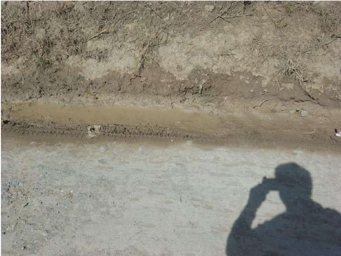
Figura 3. Se Aprecia a la Vía sin Cuneta
