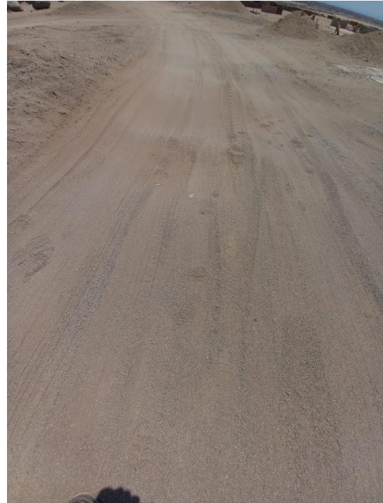
Fotografía 22. Deformación de la subrasante actualmente
