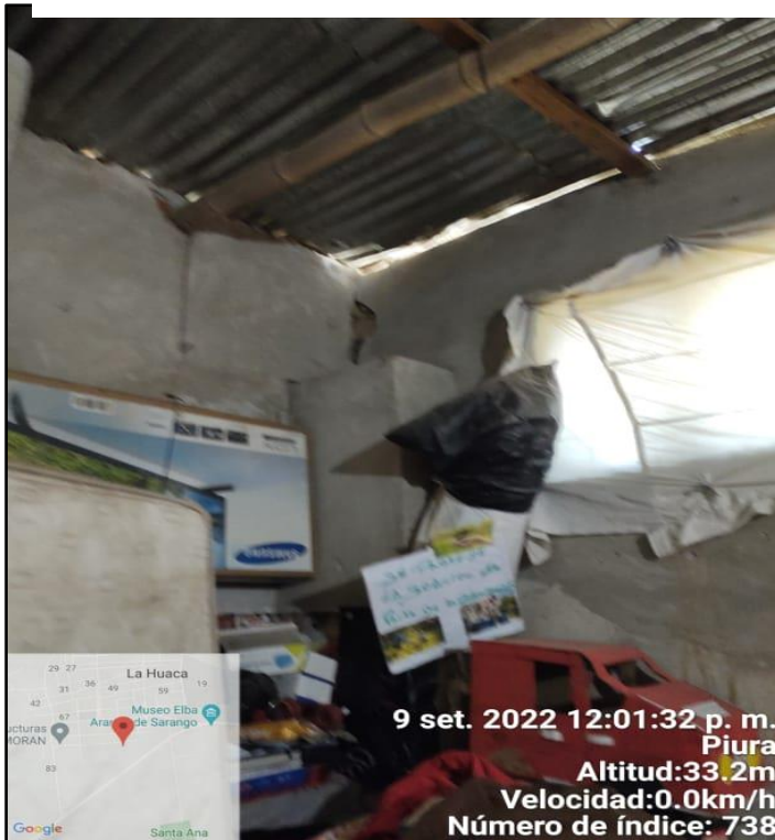
FIGURA 10: HUMEDAD EN TECHOS
