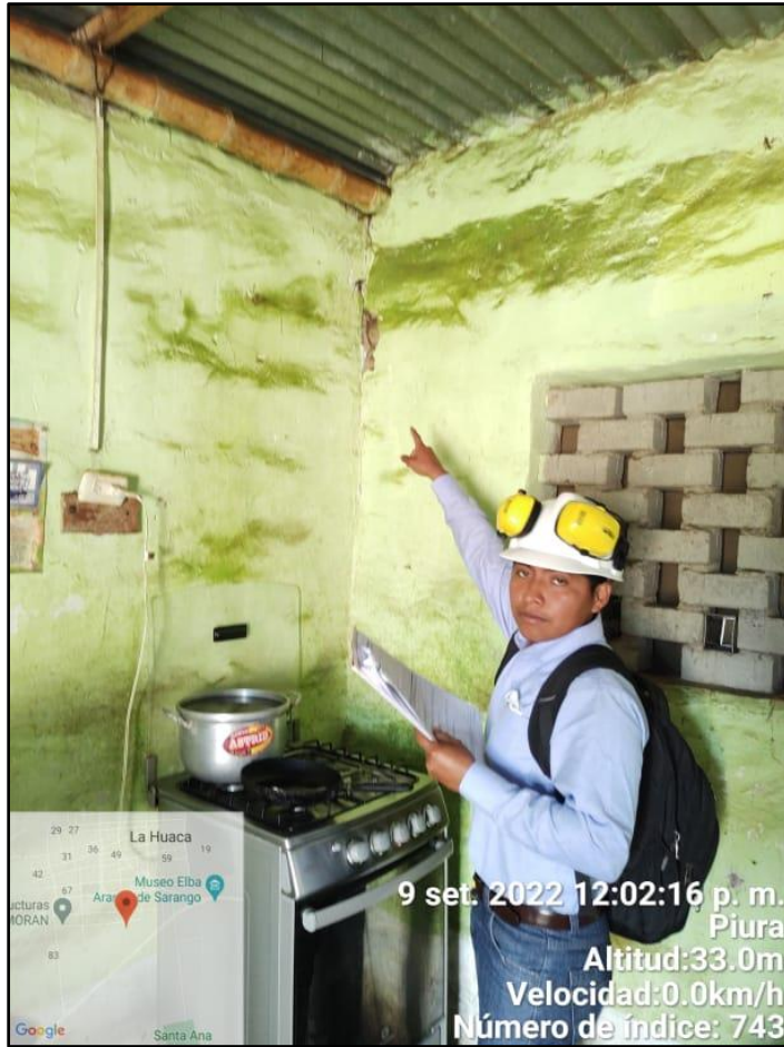
FIGURA 9: GRIETAS EN ZONAS DE EMPALME DE MUROS
