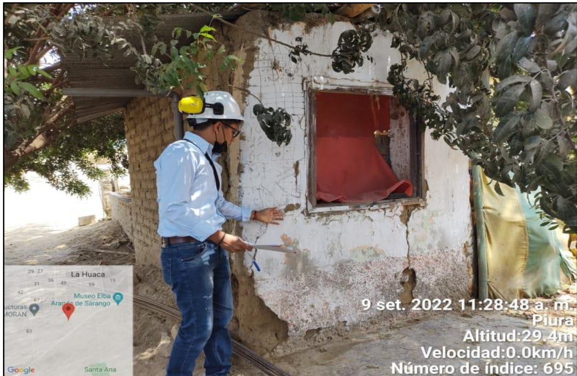
FIGURA 7: FISURAS Y GRIETAS EN FACHADA DE VIVIENDA
