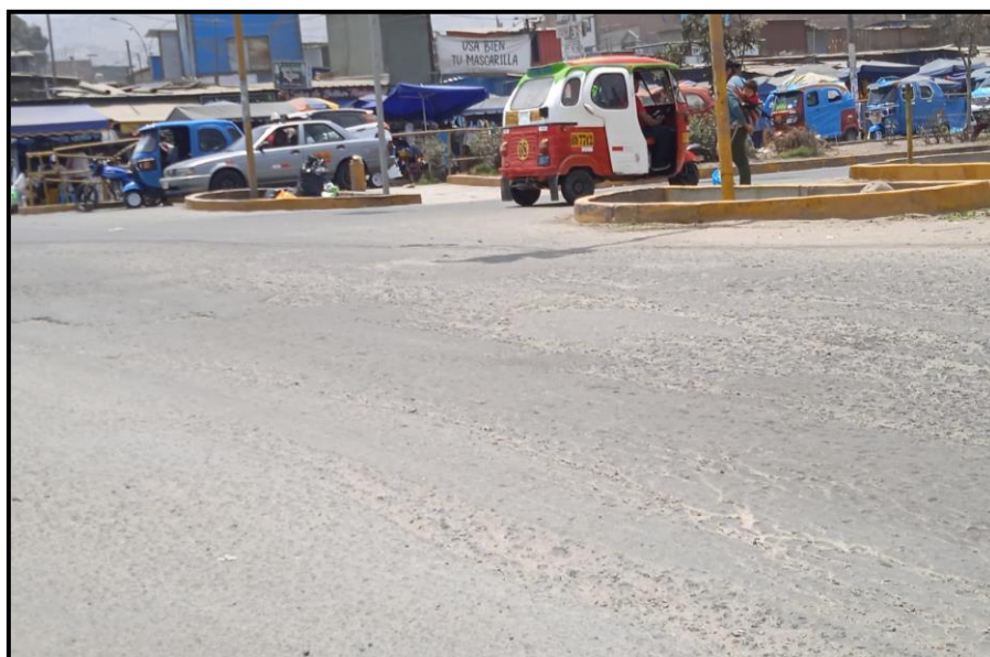
Figura 1: Pista agrietada – Cruce av. Central y av. Bayovar
