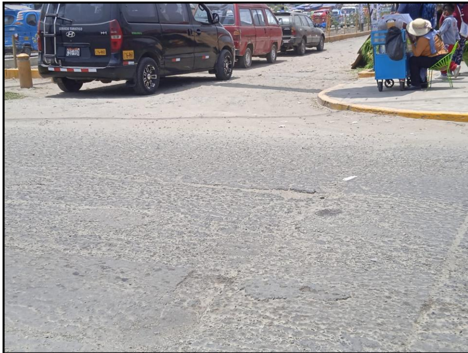
Figura 2: Pista agrietada y con capa granular expuesta – av. Bayovar
