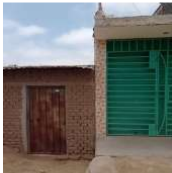
Ausencia de junta sismica
