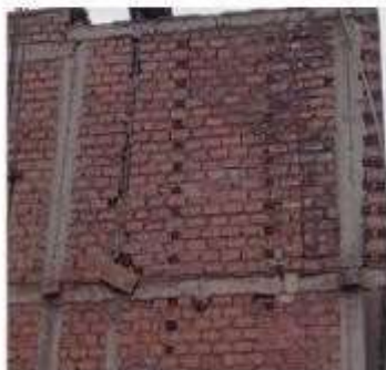
Muro sin reforzar en bajadas de tuberias
