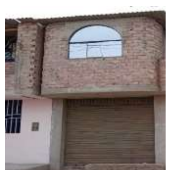
Ausencia de juntas sismicas
