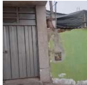
Ausencia de junta sismica
