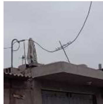
Proteccion inadecuada del acero
