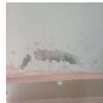
Presencia de eflorescencias en muro
