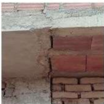
Junta fria en losas de techo
