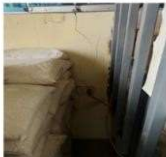
Presencia de grietas en los muros
