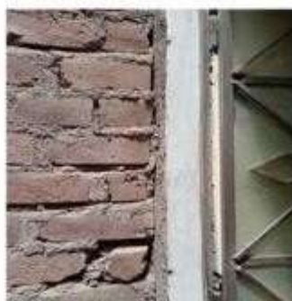
Mala union entre columna y muro
