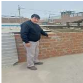
Muros de ladrillo pandereta sin arriostrar
