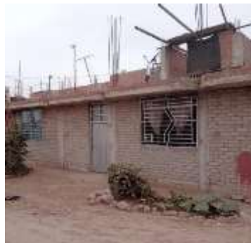
Aceros expuestos y muros sin arriostrar
