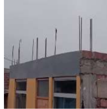
Presencia de aceros expuestos
