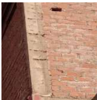
Cangrejeras en columnas
