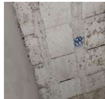
Losa desnivelada y pto. de luz en vigueta
