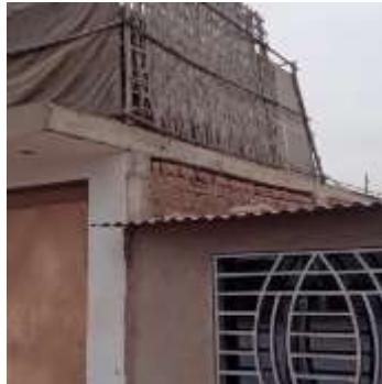
Presencia de mala union muro-techo.
