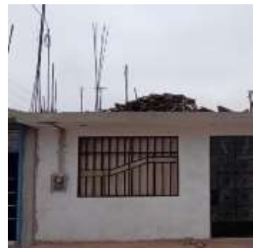
Presencia de aceros expuestos.
