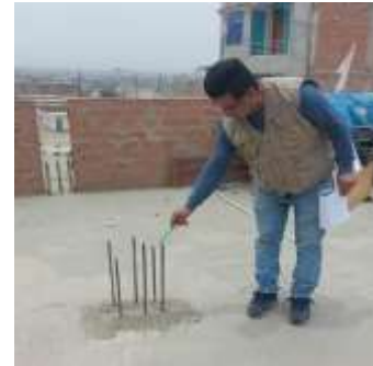
Aceros cortos y expuestos en columna
