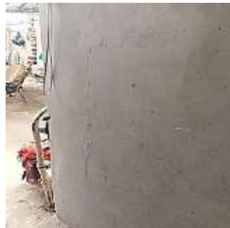
Muro con presencia de rajaduras
