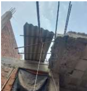
Presencia de aceros expuestos
