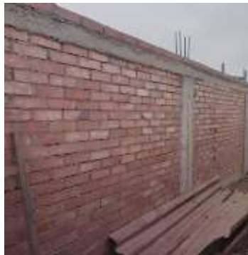
Muro sin junta completamente llena
