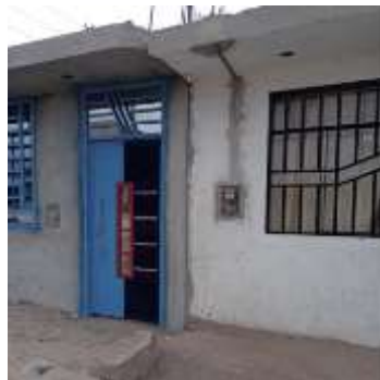
Ausencia de juntas sismicas
