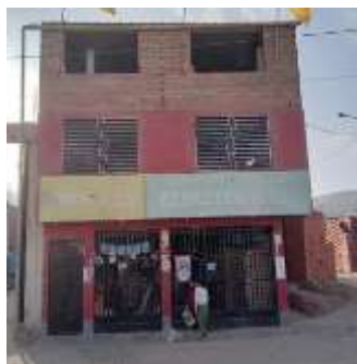
Presencia de muros sin arrostamiento
