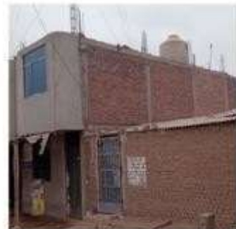
Aceros expuestos de las columnas
