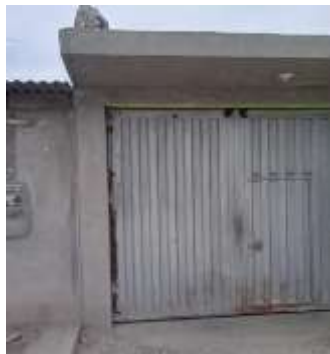
Ausencia de junta sismica
