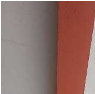
Presencia de fisuras en cielo raso
