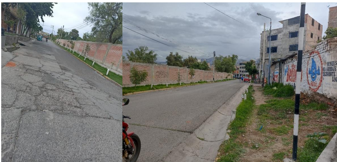
Figura 33. Vías y veredas deteriorad
