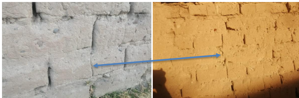
FIGURA 1 / Fallas por la baja resistencia del adobe en viviendas de Yunguyo
