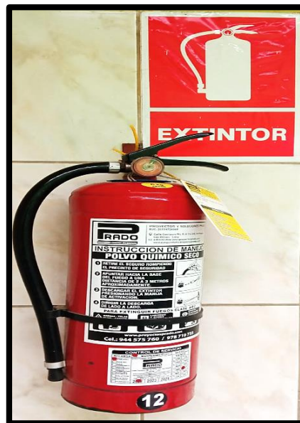
Figura 71. Señalización de equipo contra incendio Fuente: Elaboración propia
