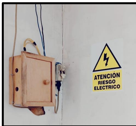
Figura 64. Señalización de prevención eléctrica
