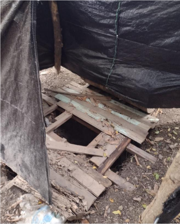
Anexo 9. Pozo ciego usado para la eliminación de excretas
