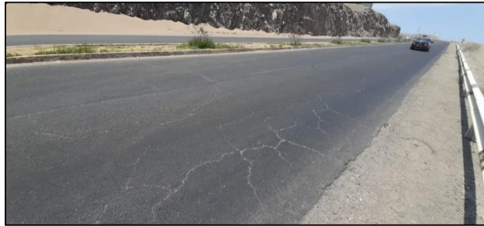
Figura 35. Fisura Transversal de la carretera MO-612
