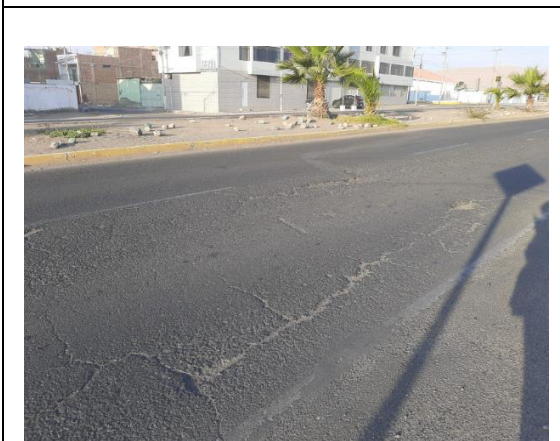
Detección de fallas
