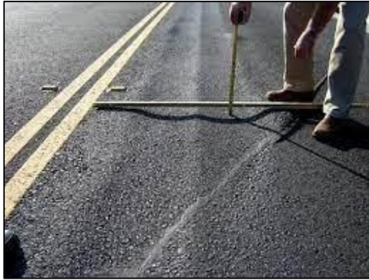
Figura 33. Deformación de ahuellamiento
