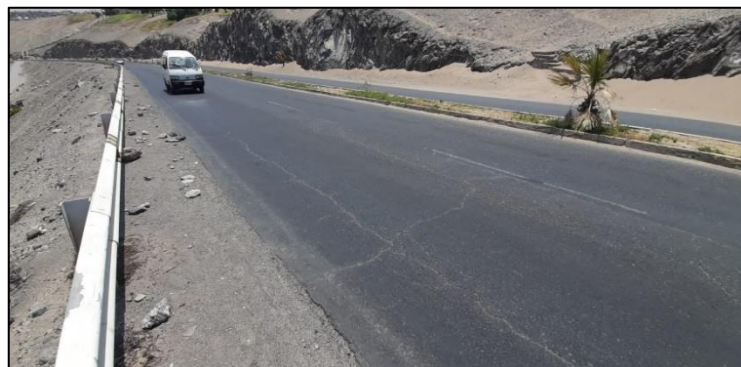
Figura 34. Fisura Longitudinal de la carretera MO-612
