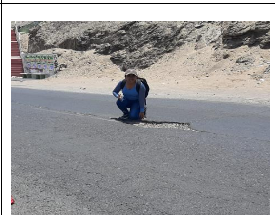
Detección de fallas
