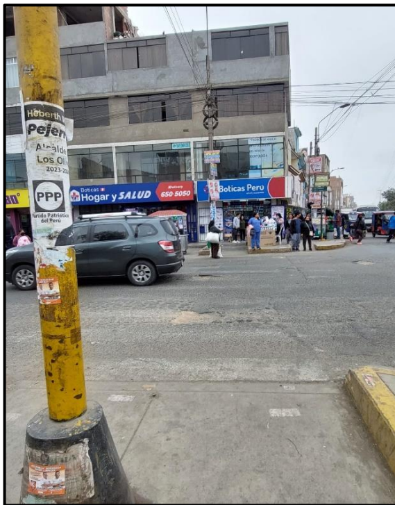
Figura 48. El pavimento presenta fallas en su capa superficial provocada por exceso de tránsito
