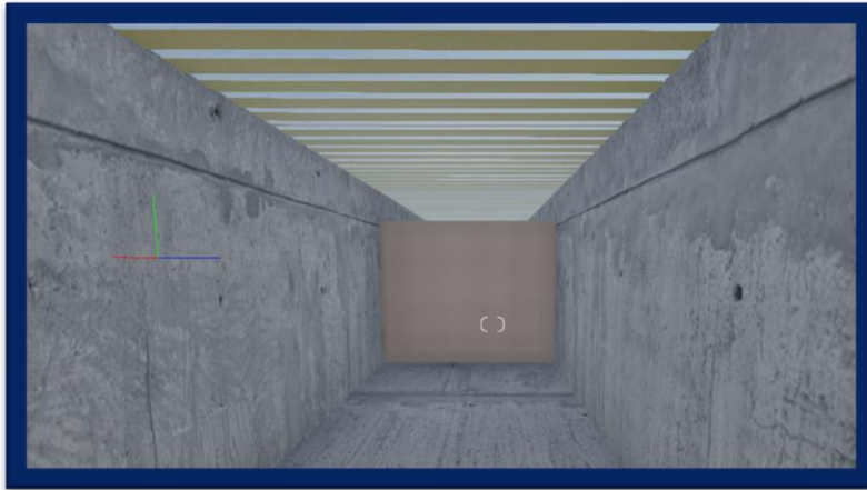
Imagen 35: Hormigón compactado al 95% interfiriendo en canal de evacuación pluvial.
