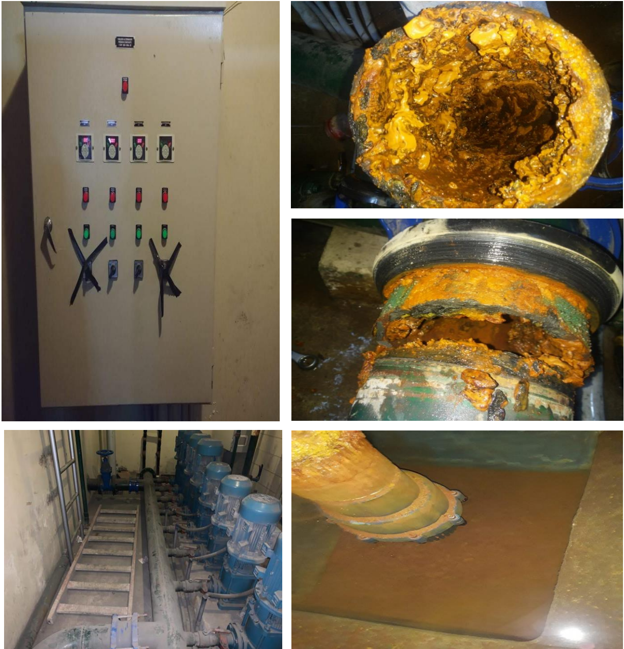
Figura 10. Tablero variador de velocidad y red hidráulica
