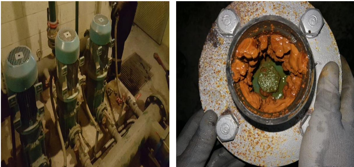
Figura 7. Sistema de bombeo (1A)
