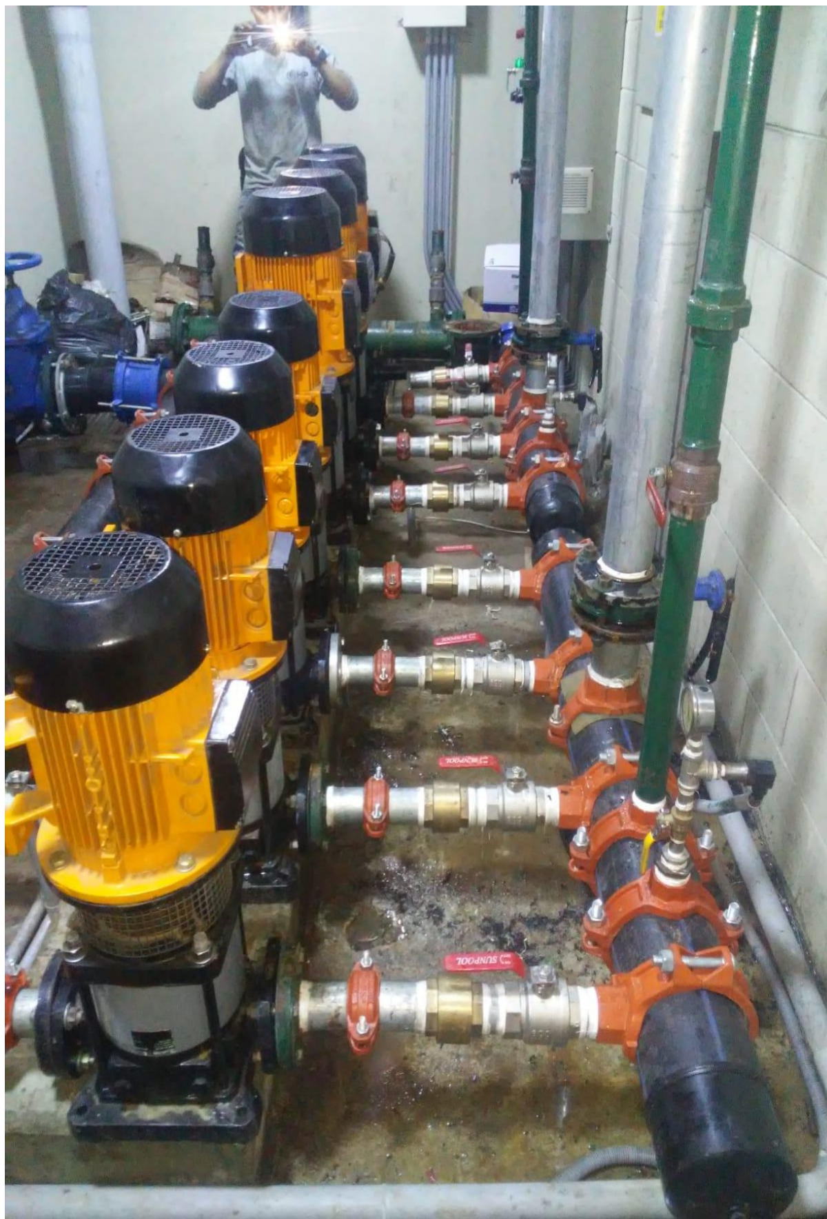
Anexo 22: Sala de máquinas – Post-Test
