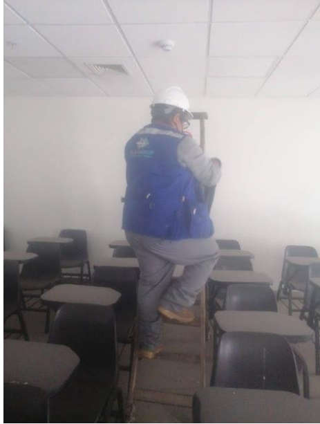
Figura 10. Mantenimiento preventivo Cmac Sullana.
