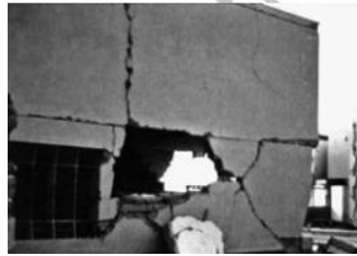
Figura 11. Falla en muros Fuente. Bartolome et al 2018
