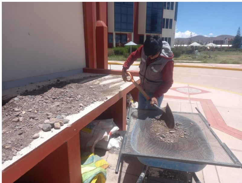
Foto 16. Separación del hormigón el agregado grueso.
