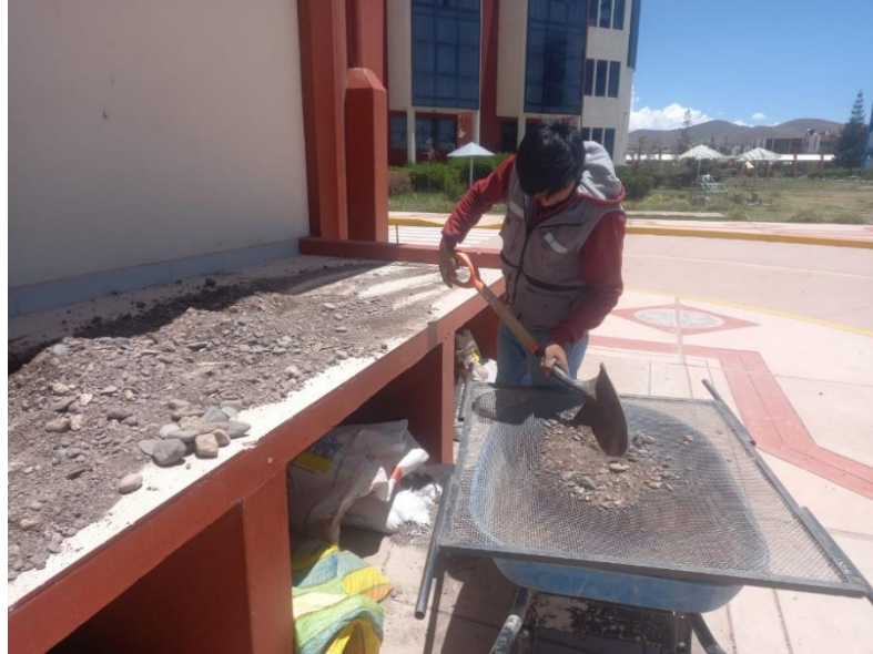
Figura 27. Separación del hormigón el agregado grueso.
