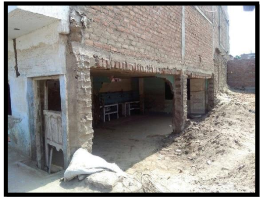
Imagen N°6: Vivienda de material noble afectada por el huayco.
