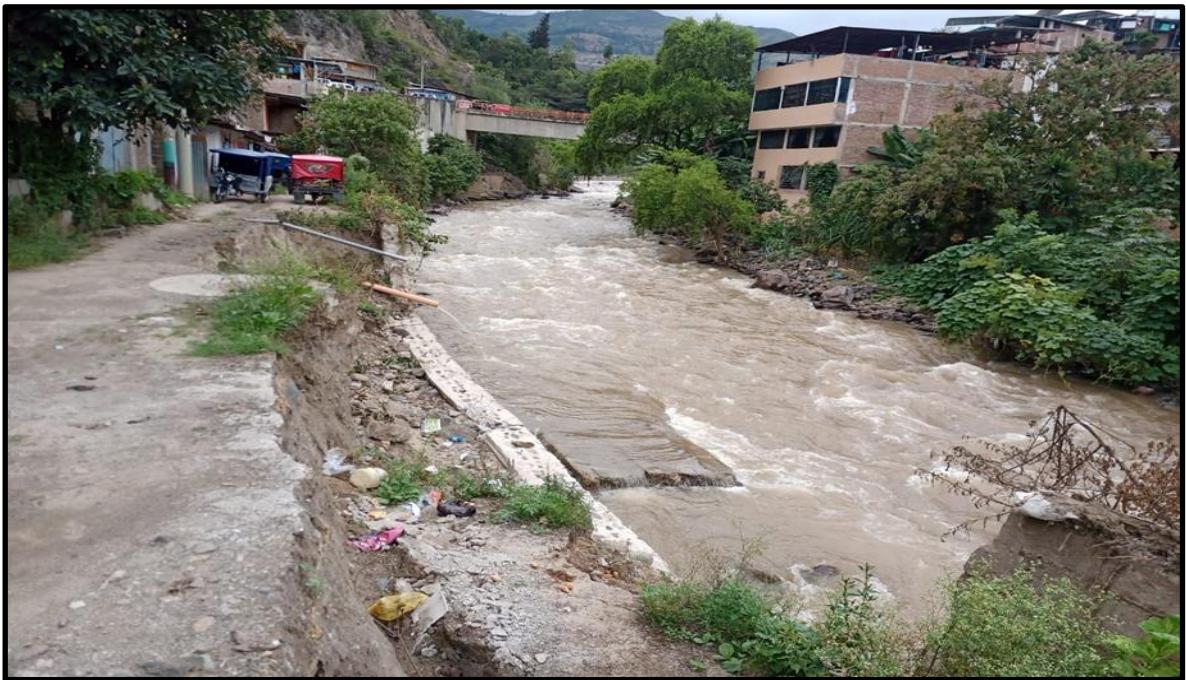
Figura 19. En esta fotografía se aprecia el pasaje el Triunfo, muro de mampostería deteriorado.
