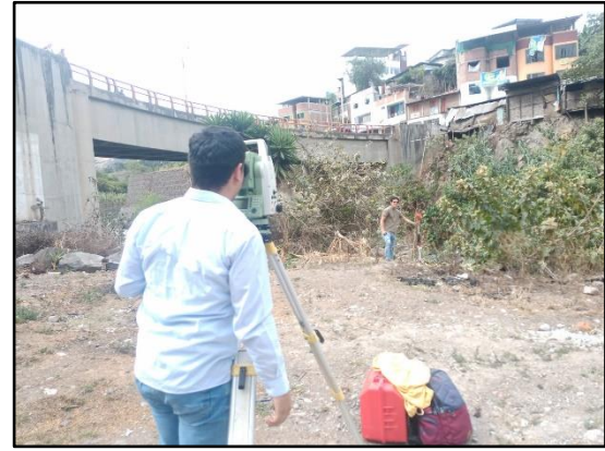
IMAGEN N 04: Se observan la toma de puntos topográficos con estación total y prisma.
