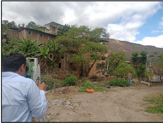
IMAGEN N 03: Se aprecian los trabajos de topografía en ribera de río en pasaje el triunfo.
