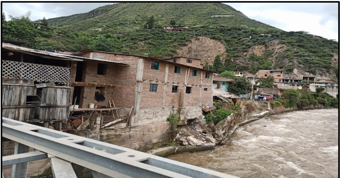
Figura 20. En esta fotografía se aprecia el muro y las viviendas colapsadas.
